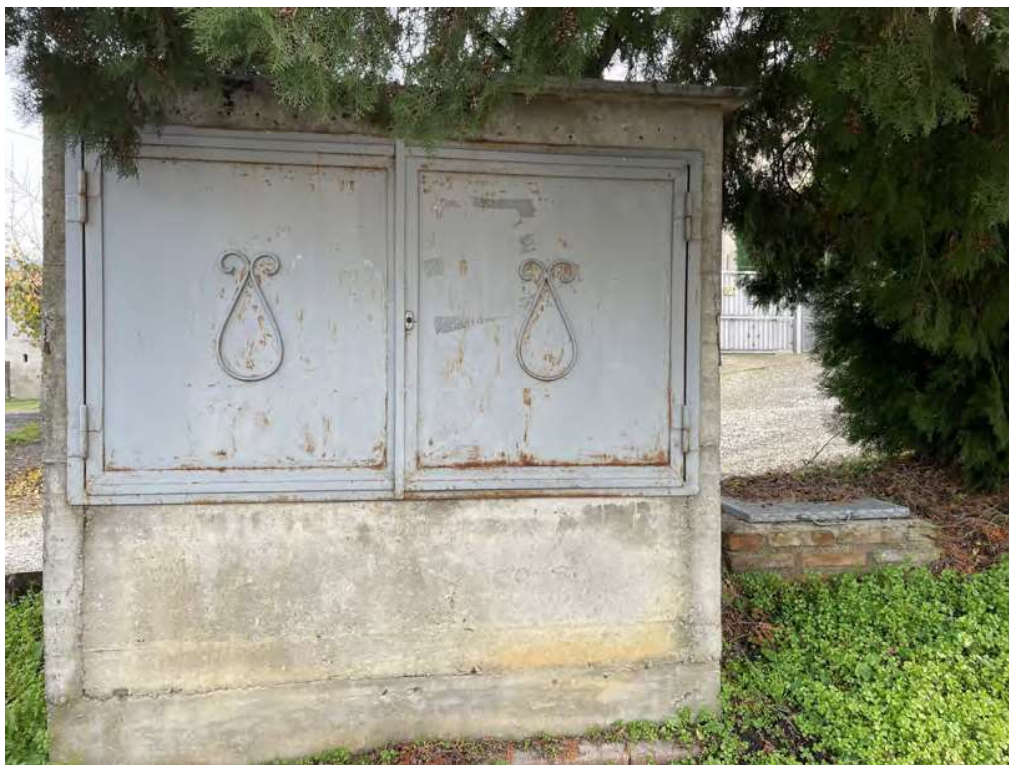
61. Contatori e pozzetto fognario.
