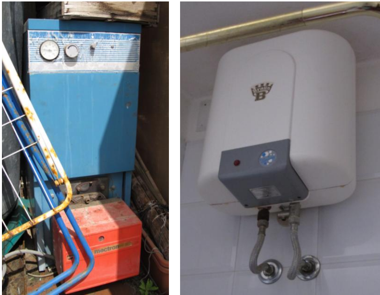
Fig. 13 e 14 – La caldaia e lo scaldacqua elettrico
