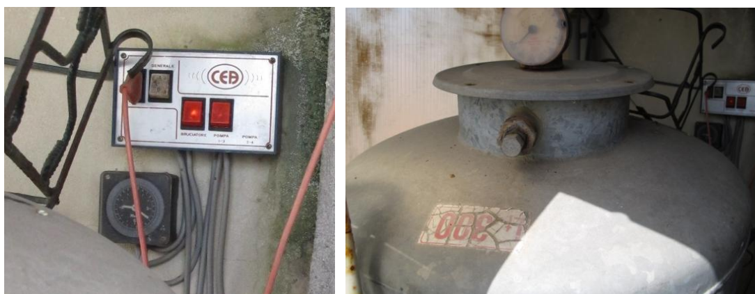
Fig. 11 e 12 – Interruttore bruciatore e pompa; serbatoio gasolio
