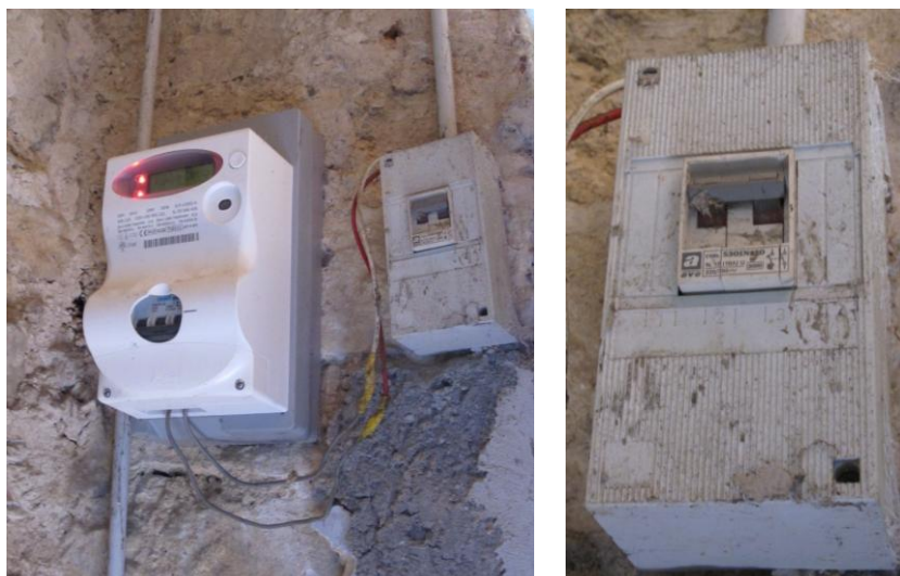
Fig. 22 e 23 – Collocazione contatore Enel e particolare interruttore magnetotermico
