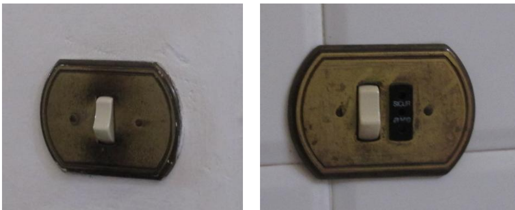
Fig. 2 e 3 – Esempio interruttori e prese installati
