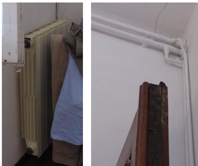
Fig. 9 e 10 – Esempio di radiatore e passaggio tubazioni
