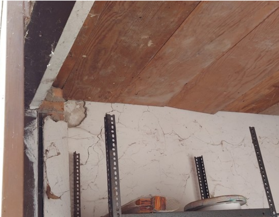
Fotografia E.5 - Danni sul muro portante
