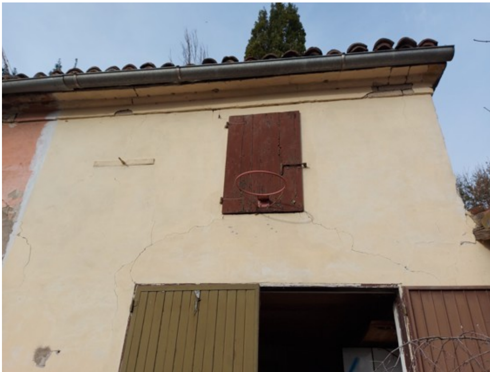
Fotografia E.8 - Danni alla copertura
