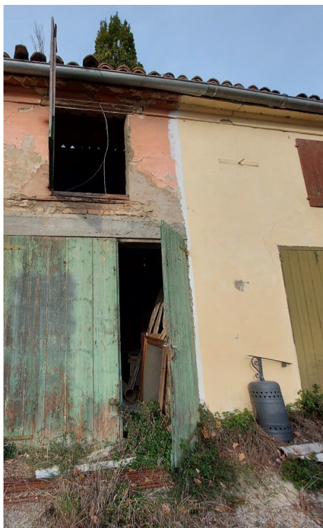
Fotografia E.9 - Falde di copertura danneggiate e muro comune tra proprietà danneggiato
