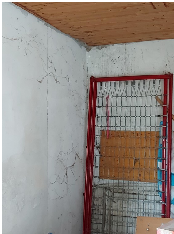
Fotografia E.6 - Danni sul muro portante
