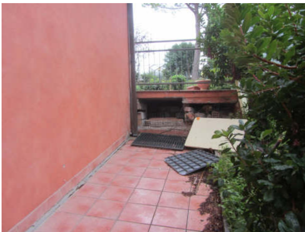
FOTO E.08_ ESTERNO_danneggiamento lastricato
