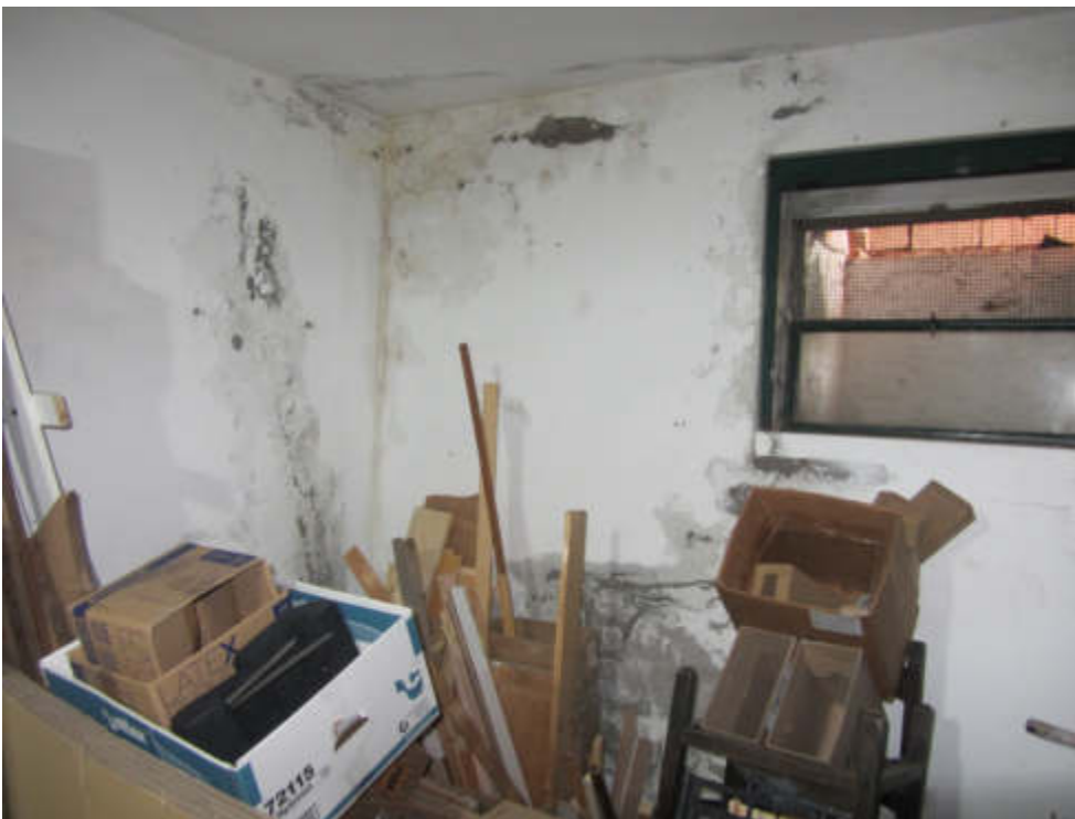
FOTO S.08_ SEMINTERRATO_ umidità a parete
