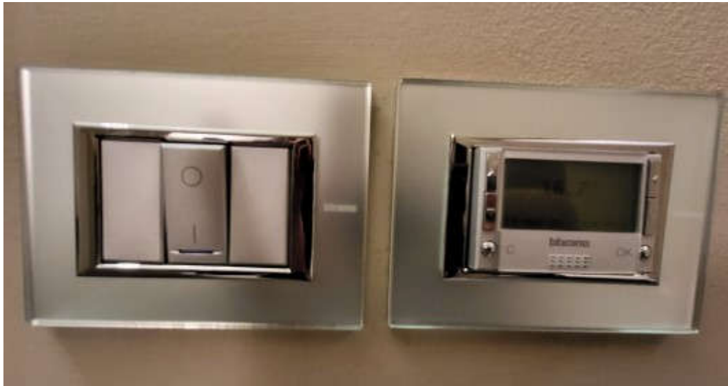
Immagine 26: termostato e interruttori elettrici appartamento
