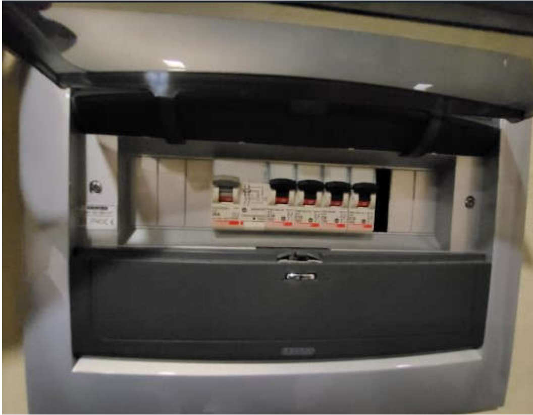
Immagine 22: quadro elettrico
