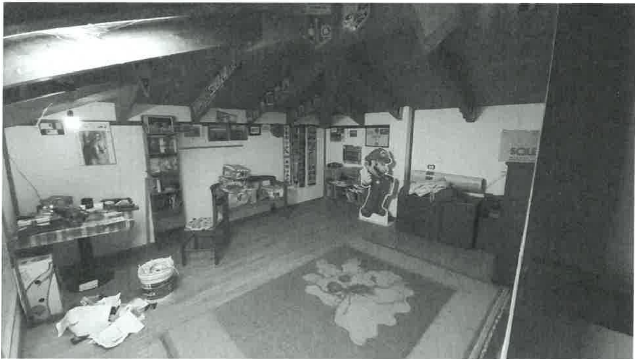
Vista su porzione di immobile al secondo piano [privo di autorizzazione edilizia]
