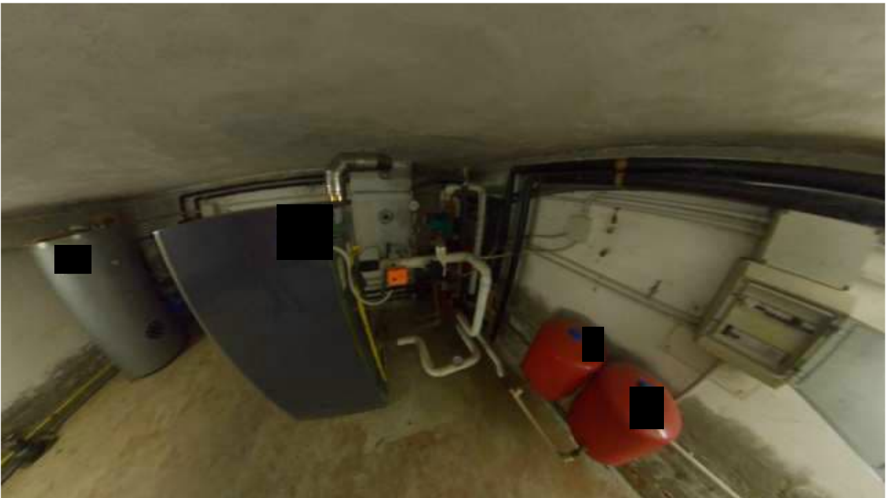
Figura 63 CENTRALE TERMICA AL PIANO SEMINTERRATO
