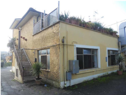
Foto n°5 - Prospetto nord del fabbricato con scala di accesso al piano 1° all'immobile pignorato
