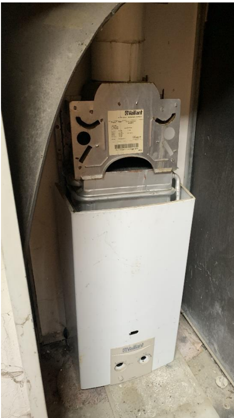
13 – Caldaia acqua calda sanitaria
