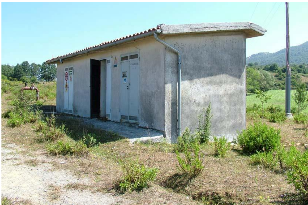
Foto 10 - Immobile (cabina a monte) foglio 3, particella 208, Sub. 1 (lato sud-ovest)
