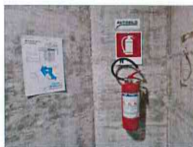
FOTO 30 - TREVI PARK IMPIANTI
