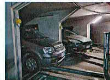
FOTO 21 - TREVI PARK VISTA AUTOVETTURE PARCHEGGIATE
