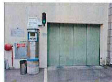
FOTO 06 - VISTA DEGLI IMPIANTI DI ACCESSO E SICUREZZA AUTOSILO
