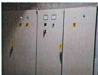
FOTO 29 -TREVI PARK IMPIANTI
