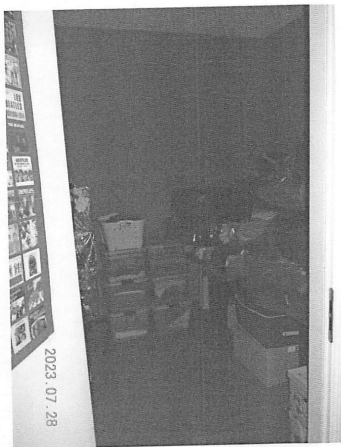
LOCALE 4 DEPOSITO/ARCHIVIO PIANO PRIMO DA SANARE
