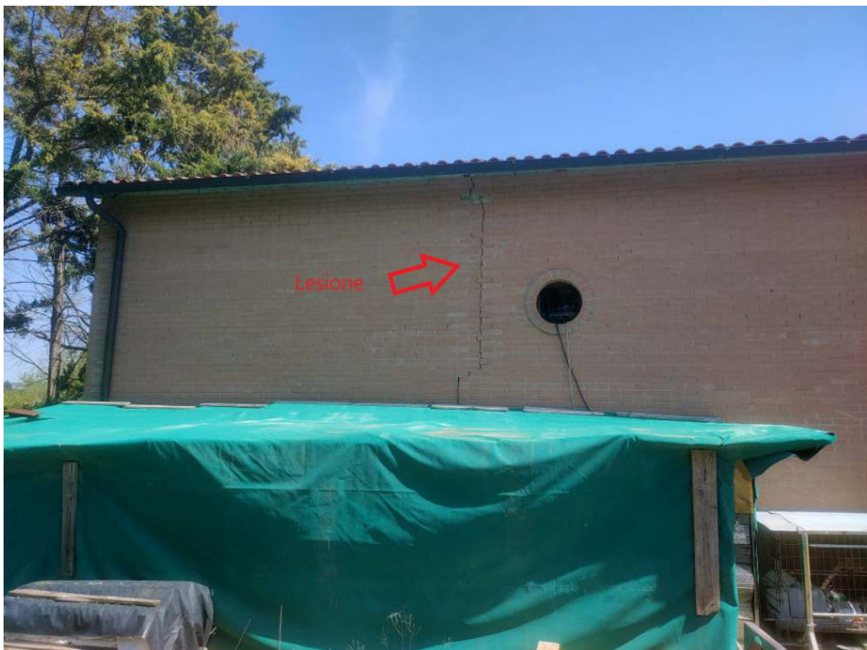
Particolare della lesione strutturale lato Nord-Ovest, dovuta dallo smottamento del terreno verso valle
