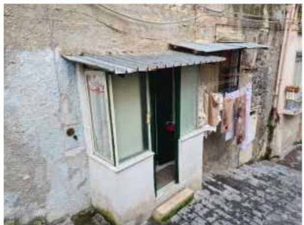
Ingresso abusivo all'immobile
