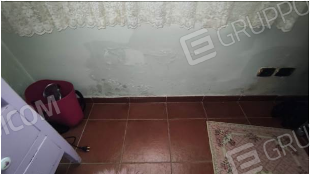
Foto n° 49: Piano Seminterrato – ripostiglio – particolare umidità di risalita
