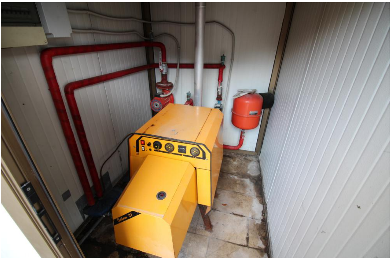
FOTO 16 – locale tecnico caldaia impianto termico
