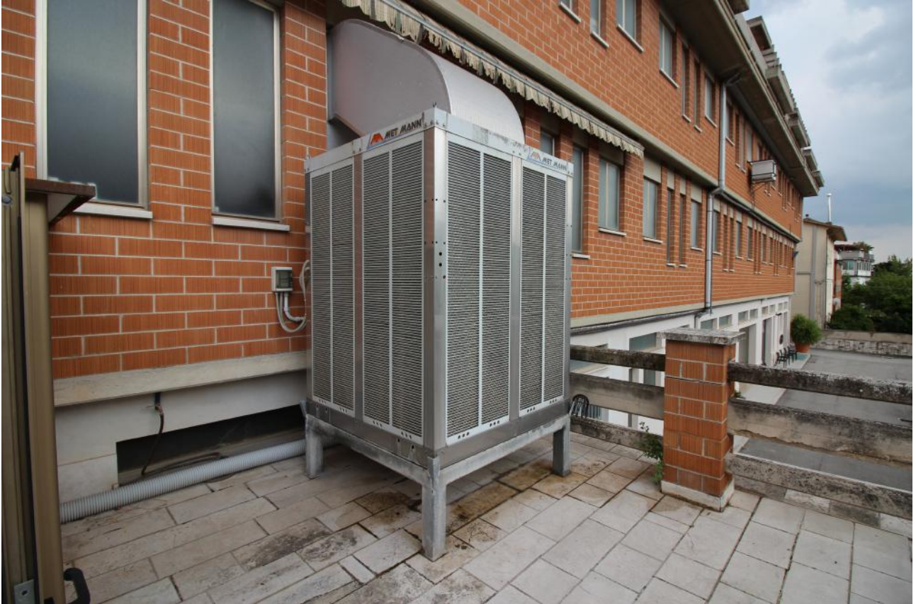
FOTO 15 – locale tecnico macchina raffreddamento
