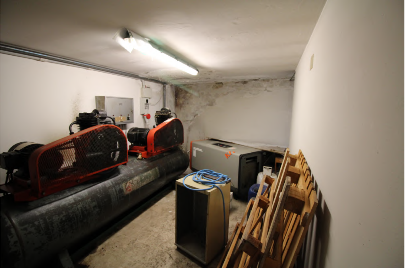
FOTO 49 – vista interna locale compressore
