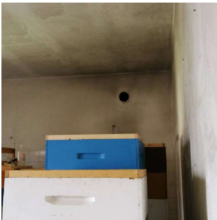
Figura 87: Foglio 24, mappale 143, sub.6 - parete soggiorno con muffa
