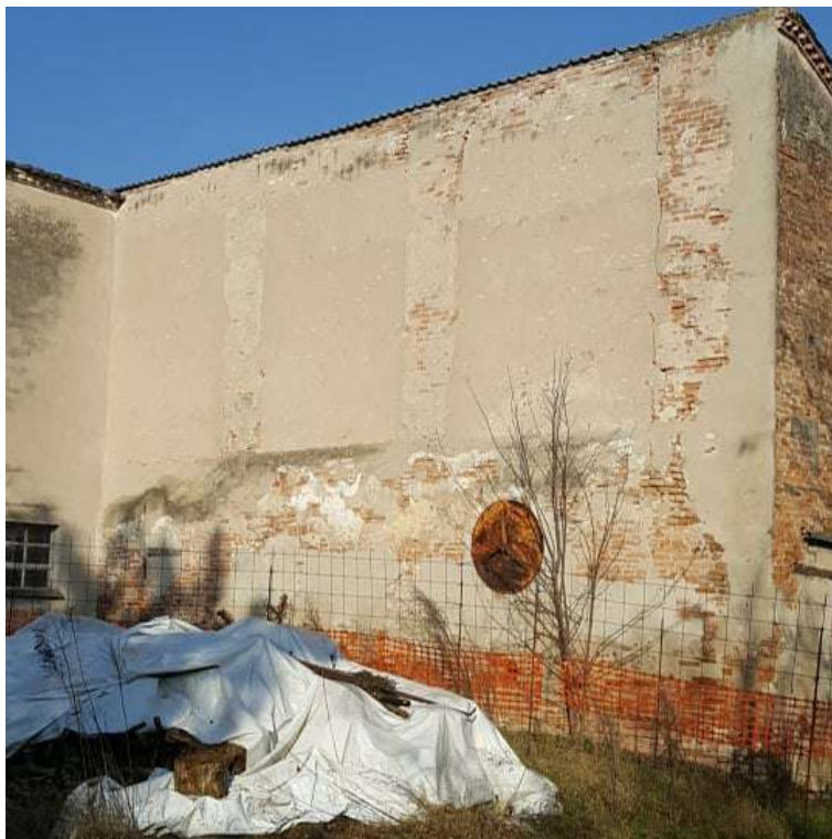
Figura 19: Foglio 24, mappale 143, sub. 1 - Presenza di lesioni (vista da sud)
