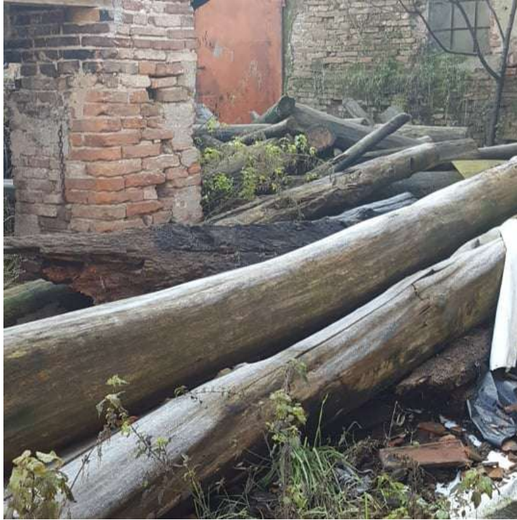
Figura 25: Foglio 24, mappale 143, sub. 1 - Travi crollate e materiale vario (vista da Nord)
