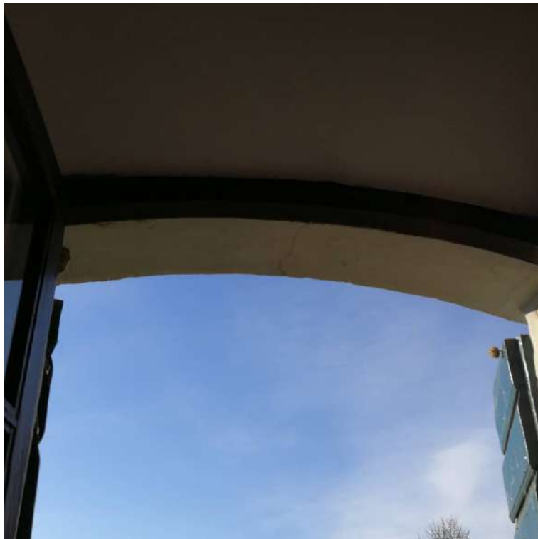
Figura 60: Foglio 24, mappale 143, sub.5 - lesione nel soprafinestra (camera da letto singola)
