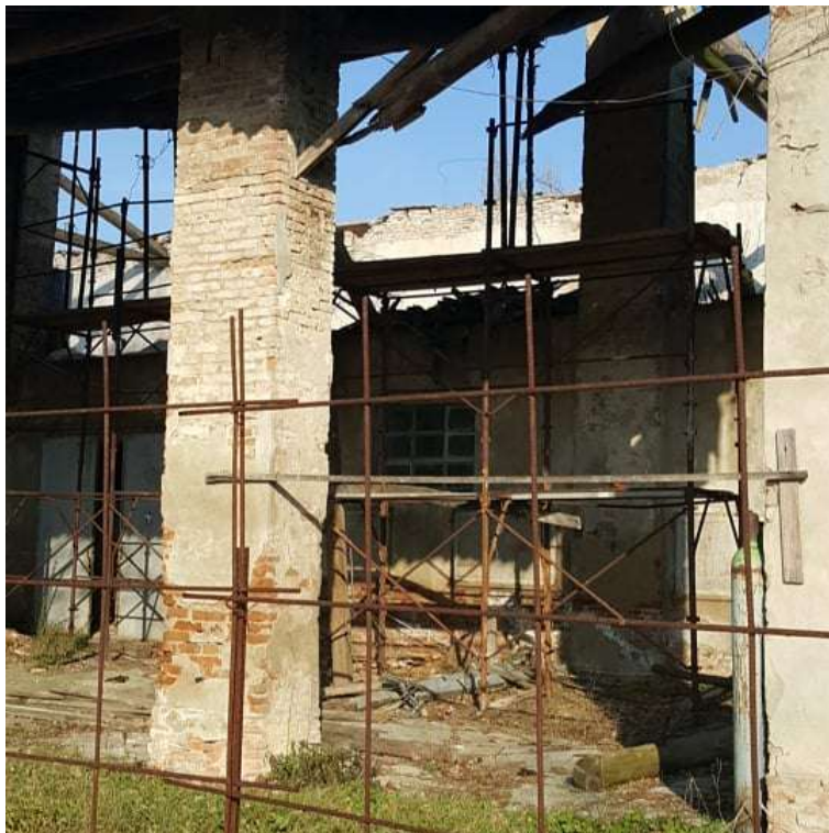
Figura 27: Foglio 24, mappale 143, sub.2 - tetto crollato (vista da Sud)
