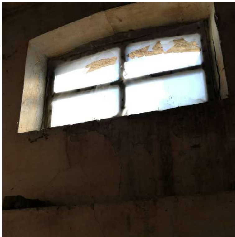
Figura 54: Foglio 24, mappale 143, sub.5 - Finestra rotta (scale)
