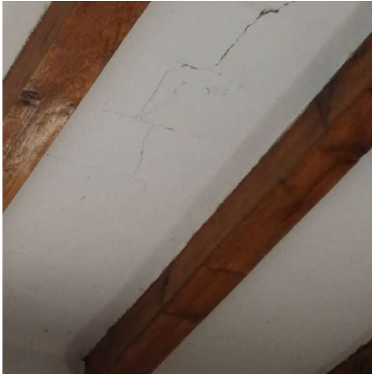
Figura 49: Foglio 24, mappale 143, sub.5 - Lesioni soffitto (ingresso)
