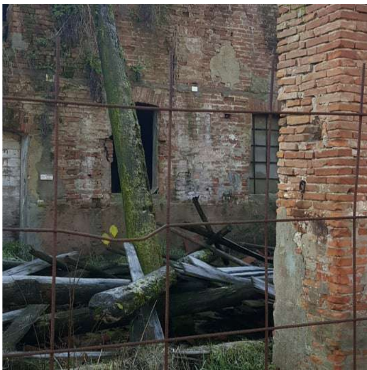
Figura 20: Foglio 24, mappale 143, sub. 1 -Travi del tetto crollate (vista da nord)
