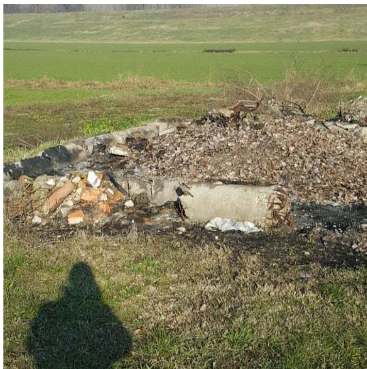
Figura 127: Foglio 24, mappale 143, sub.7 - rifiuti presenti su area cortiliva (vista da ovest)
