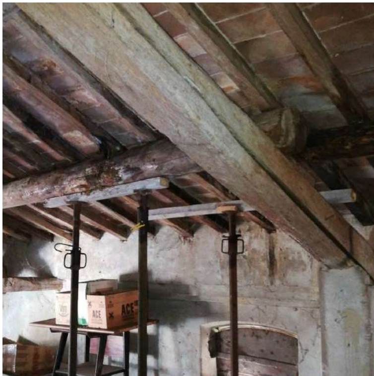
Figura 73: Foglio 24, mappale 143, sub.5 - soffitta con trave soggetta ad un pesante attacco di insetti xilofagi
