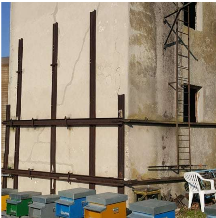
Figura 31: Foglio 24, mappale 143, sub.3 - lesioni (vista sud-est)
