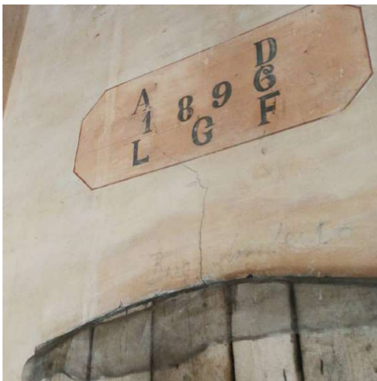
Figura 64: Foglio 24, mappale 143, sub.5 - parete vano scale
