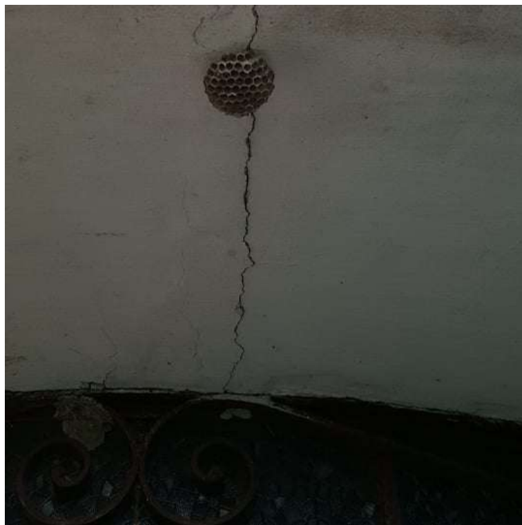
Figura 37: Foglio 24, mappale 143, sub.5 - lesioni nella muratura sopra la porta di ingresso
