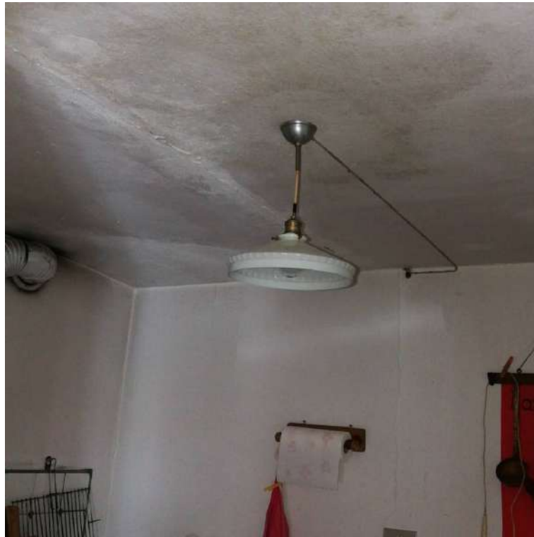
Figura 41: Foglio 24, mappale 143, sub.5 - soffitto cucina
