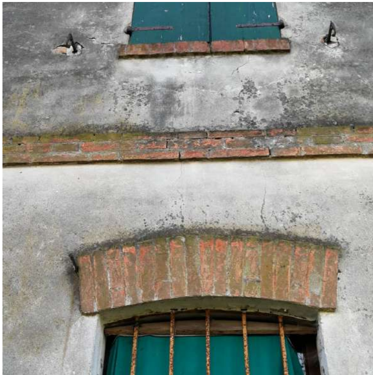
Figura 79: Foglio 24, mappale 143, sub.5 - parete esterna con lesione
