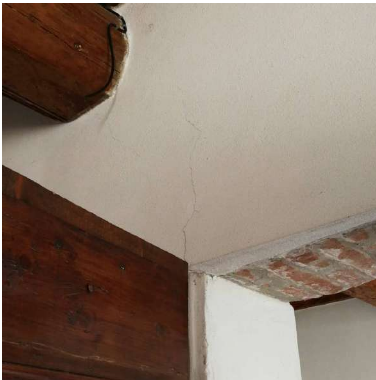
Figura 50: Foglio 24, mappale 143, sub.5 - Lesioni muratura verticale tra soggiorno e corridoio
