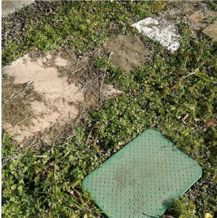
Figura 80: Foglio 24, mappale 143, sub.5 - pozzetto impianto di irrigazione
