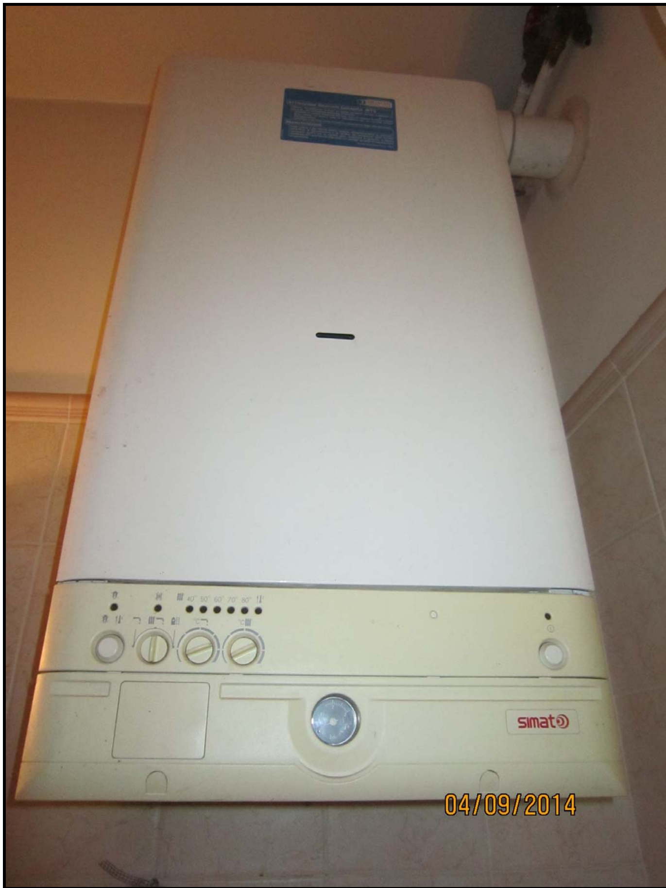
FOTO N. 10 - CALDAIA POSIZIONATA NEL BAGNO
