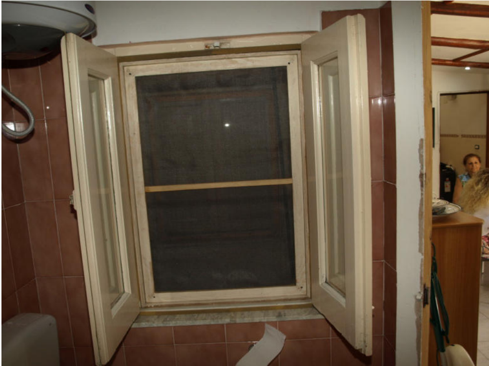
Foto n° 19 – Appartamento per civile abitazione sito in Gela con ingresso dalla via Dinomane n° 18, quarto piano – Foglio 187 part. 1057 sub 7 – Panoramica degli interni (finestra su pozzo luce).
