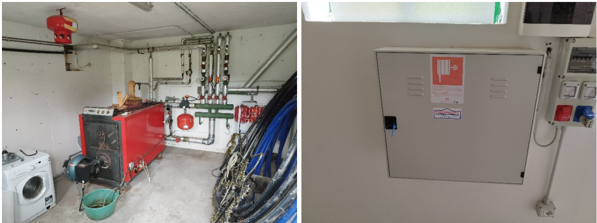
Particolare centrale termica e impianto antincendio
