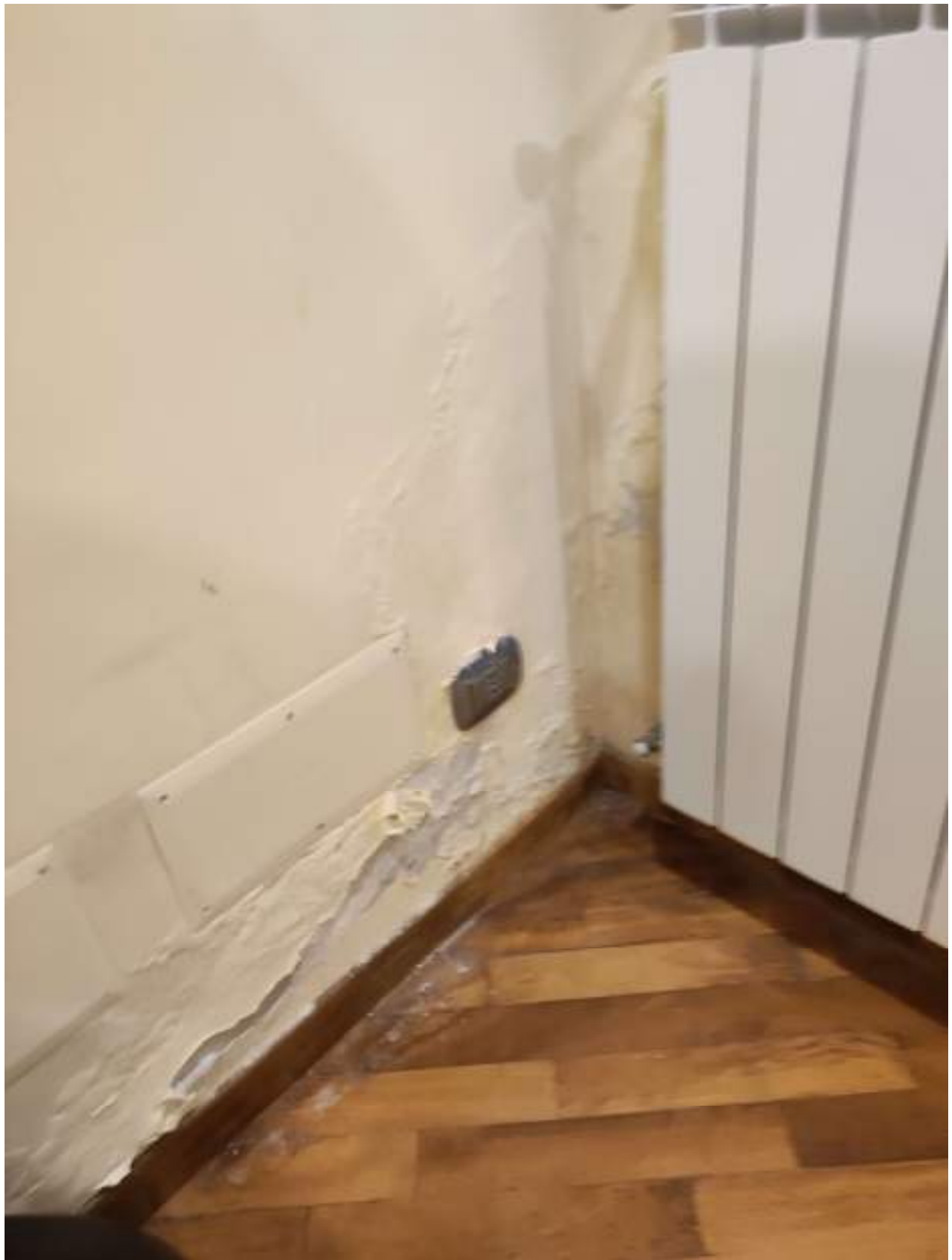
Foto 42 Umidità di risalita con distacco di intonaco (Piano Seminterrato)
