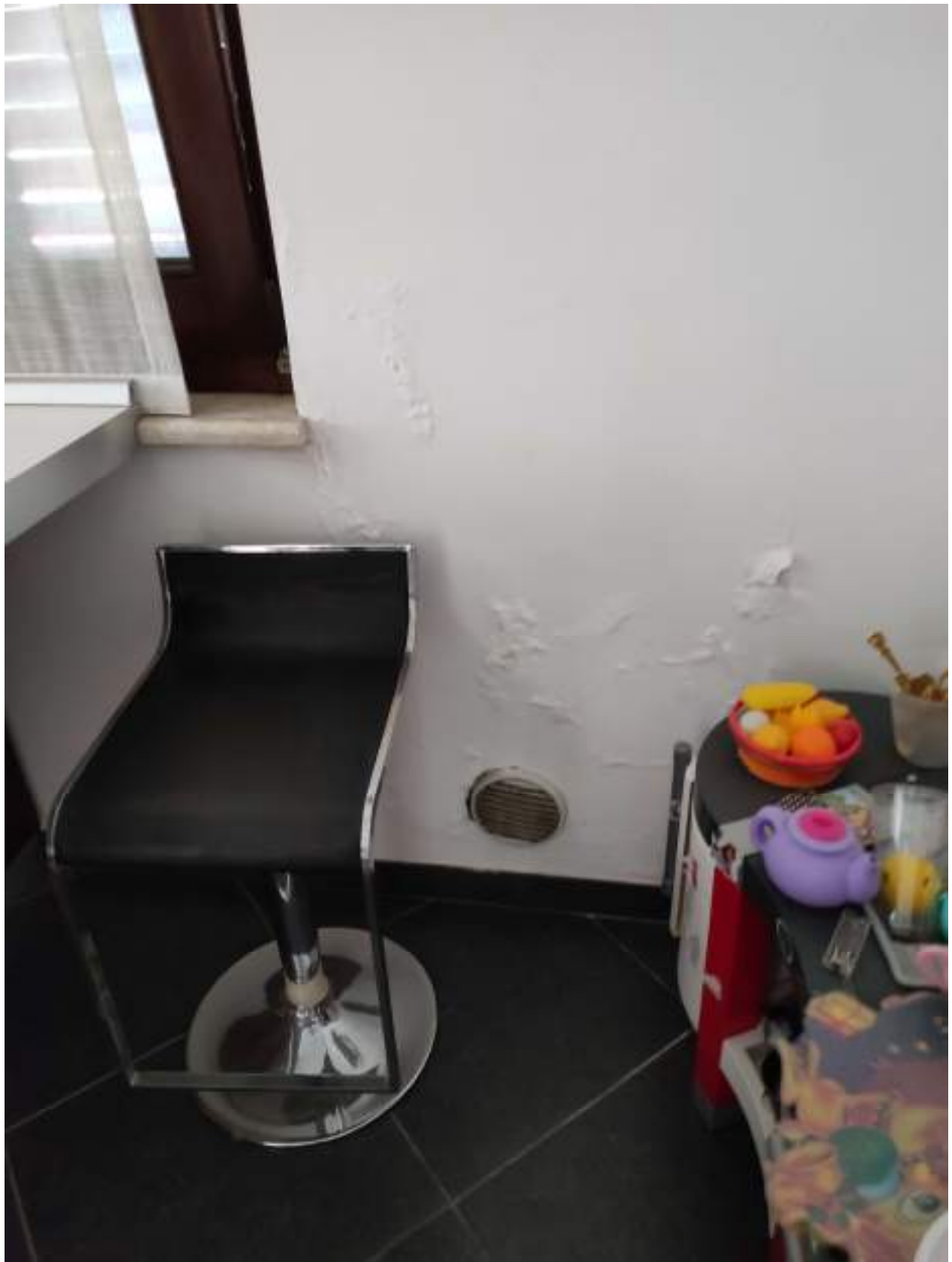
Foto 11 Locale cucina – Umidità di risalita con distacco intonaco (Piano Terra)
