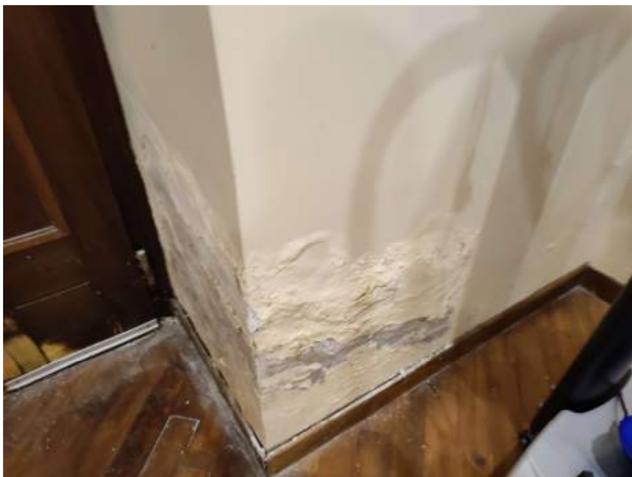
Foto 43 Umidità di risalita con distacco di intonaco (Piano Seminterrato)
