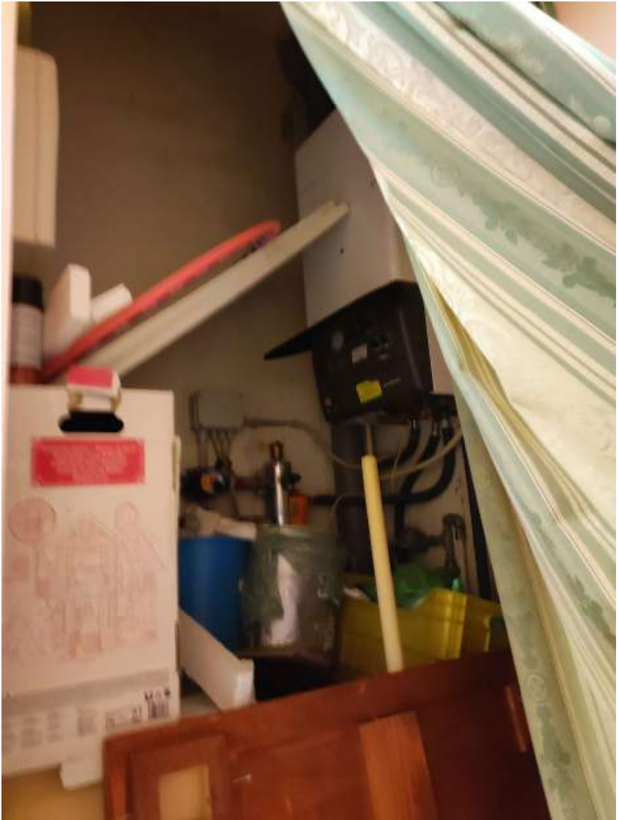
Foto 36 Centrale Termica (Piano Seminterrato)
