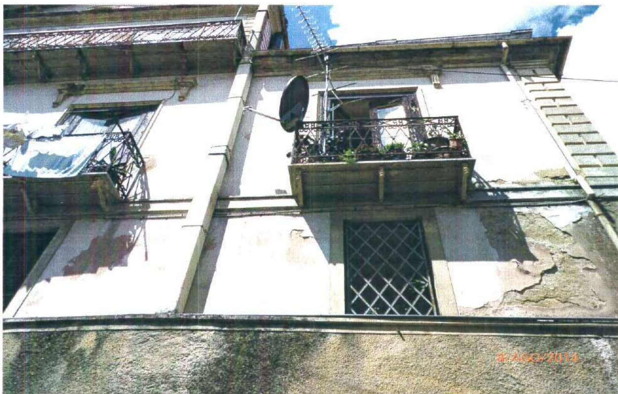
UMIDITA' SULLA FACCIATA OVEST
