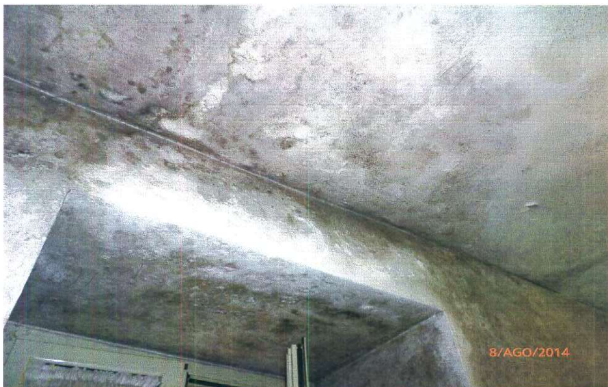
PARTICOLARE INFILTRAZIONE D'ACQUA
