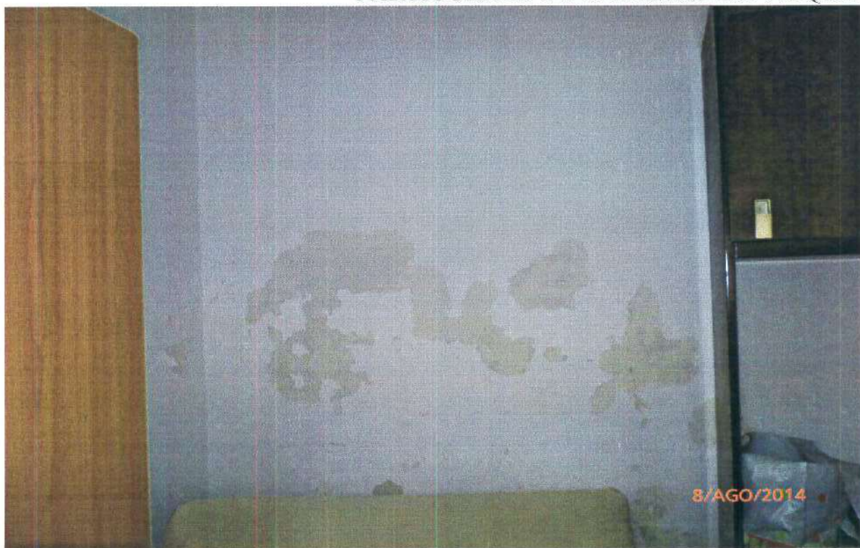
PARTICOLARE INFILTRAZIONE D'ACQUA
