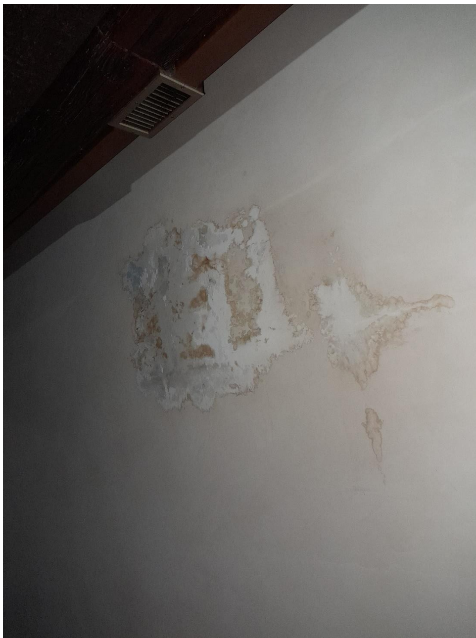
FOTO N.22_ Infiltrazione muro soggiorno piano terra
