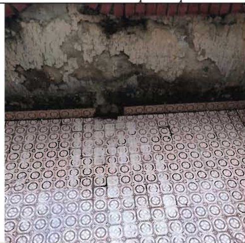
Problemi di infiltrazione terrazzo piano primo
