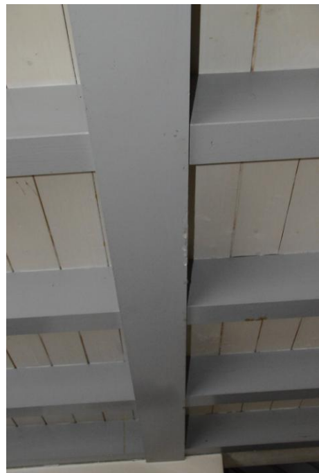
Foto 18 – Infiltrazioni d'acqua nel solaio del piano primo
