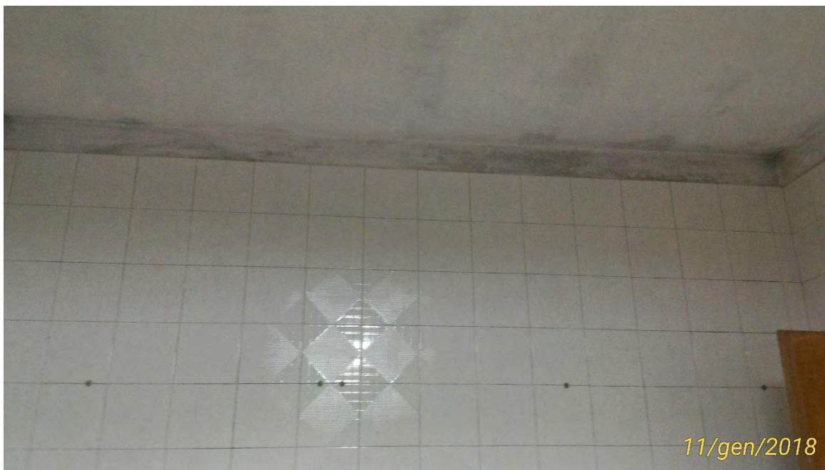
Fig. 27 – Visione particolareggiata umidità nei solai
