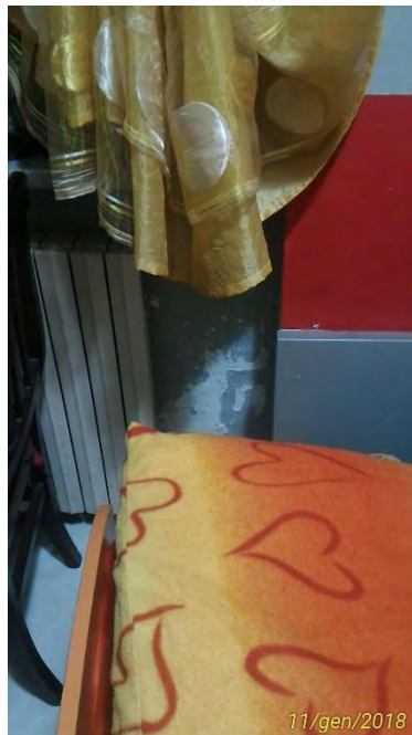
Fig. 22 – Visione particolareggiata umidità nella camera dei bambini
