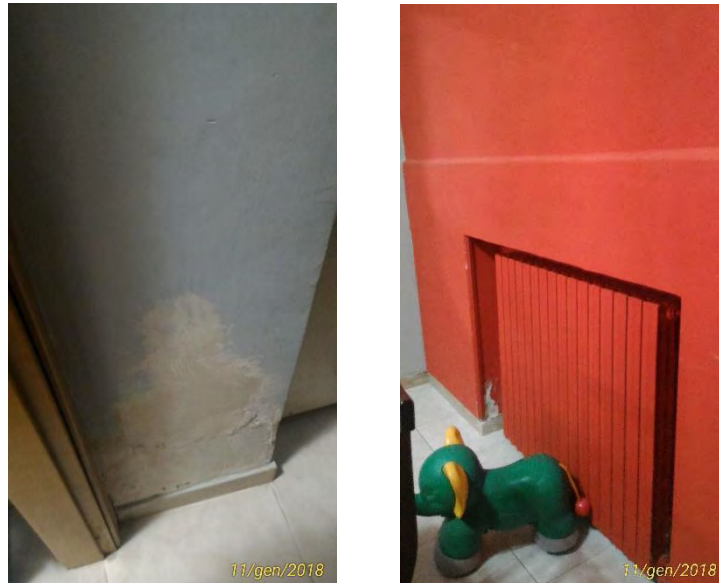
Fig. 24 e 25 – Visione particolareggiata umidità
