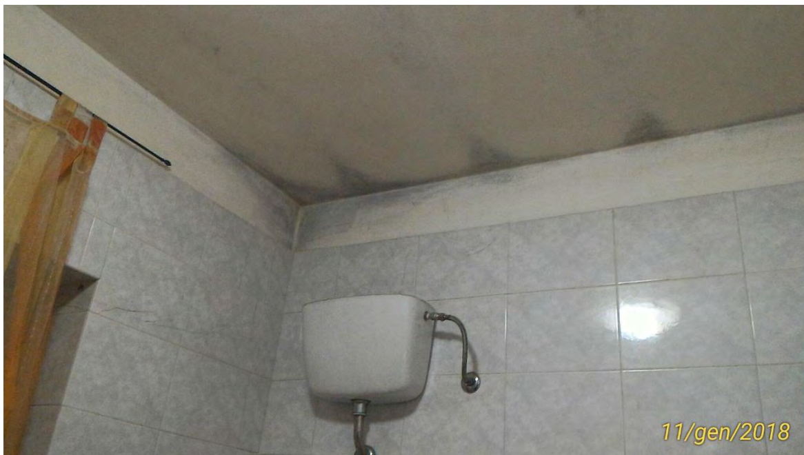
Fig. 26 – Visione particolareggiata umidità nei solai
