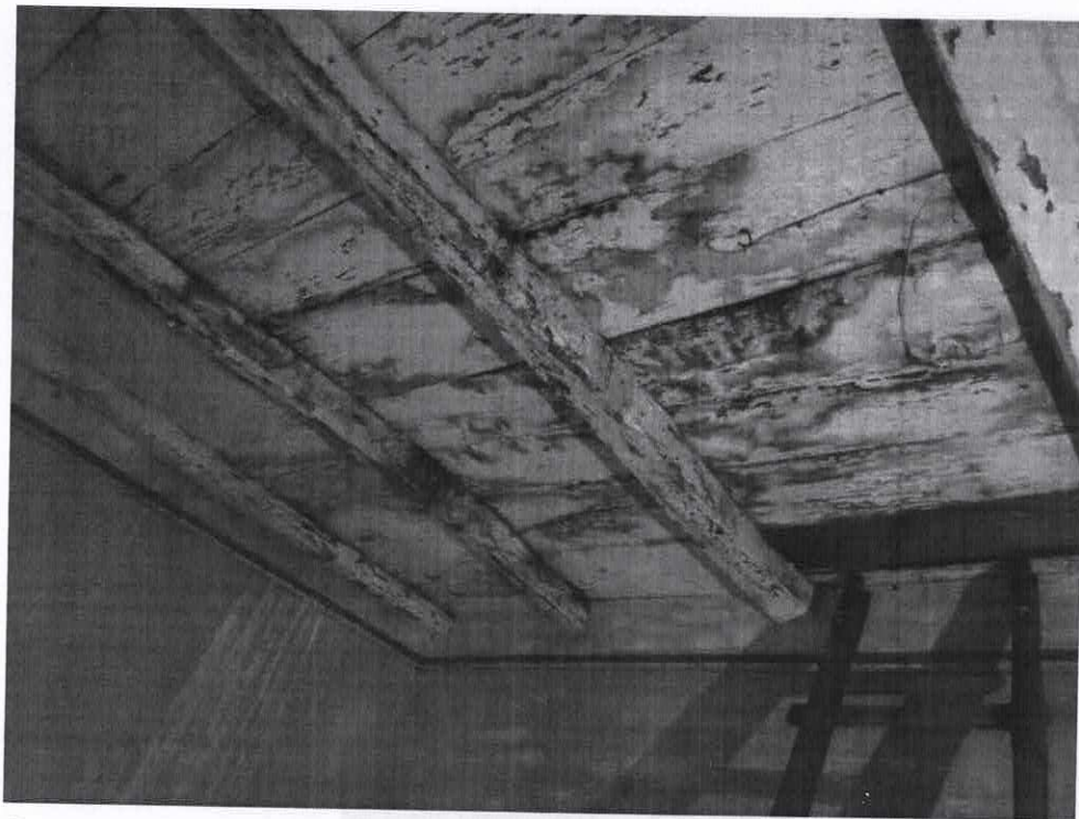
Foto n°25: marcescenza solaio di copertura del piano primo
