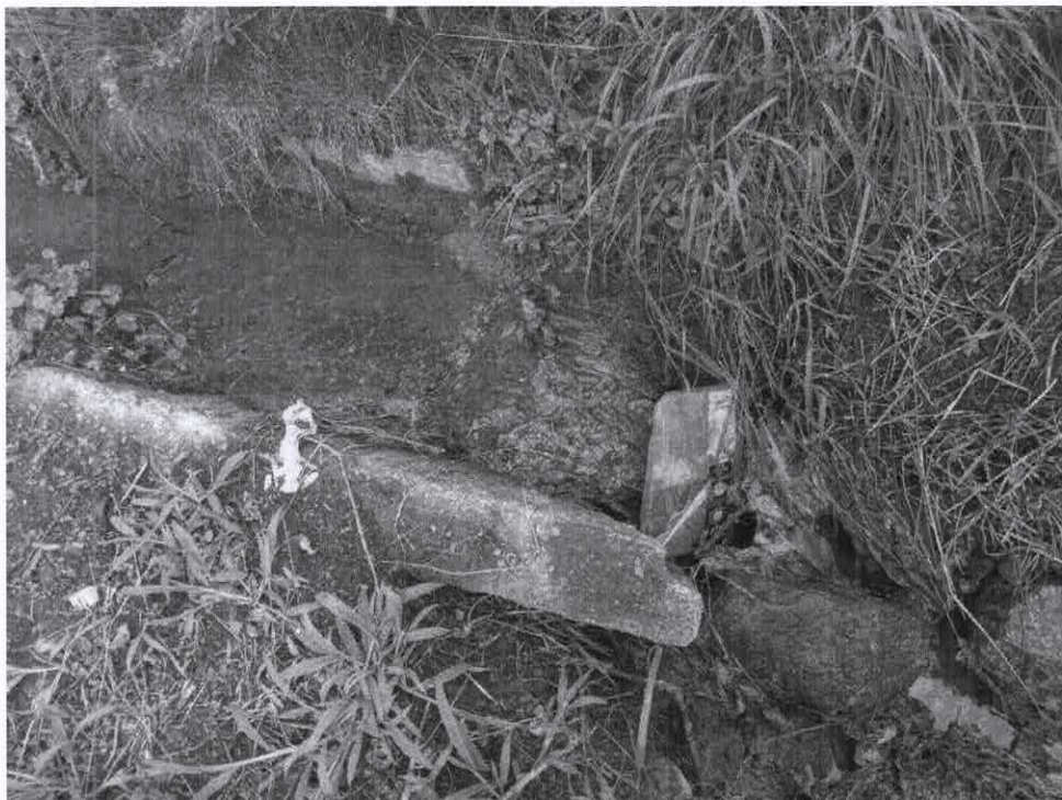
Foto n°20: materiale depositato dai reflui fognari
