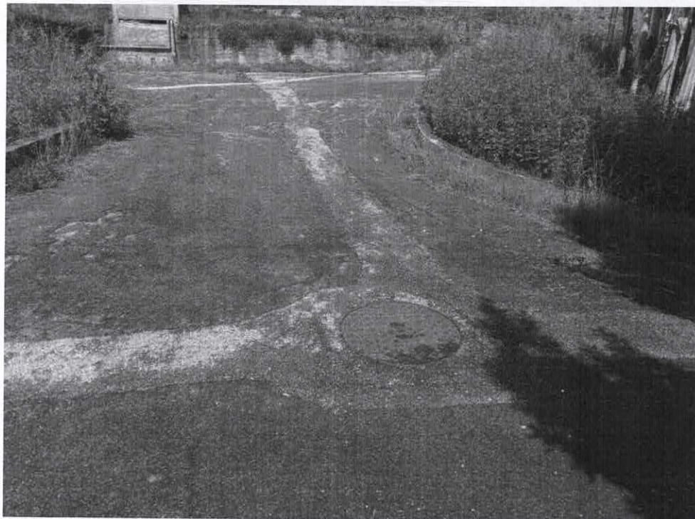
Foto n°10: tracciato della fognatura sulla proprietà
