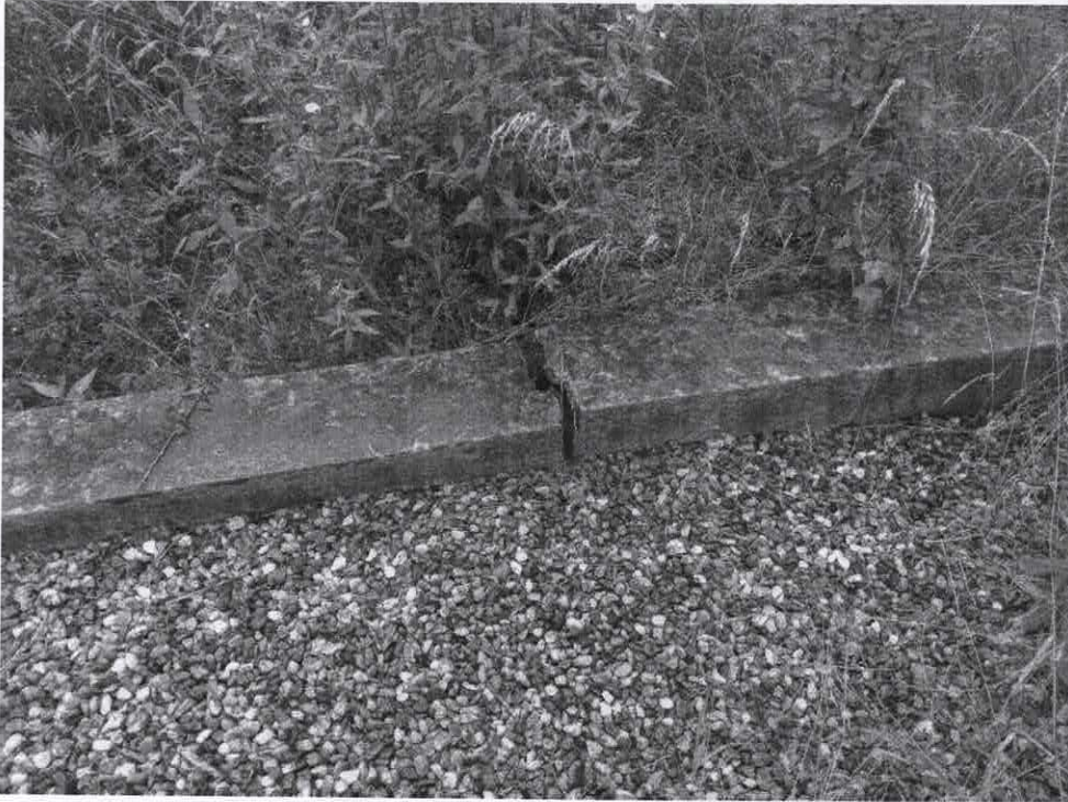
Foto n°15: dettaglio frattura cordolatura della foto precedente
