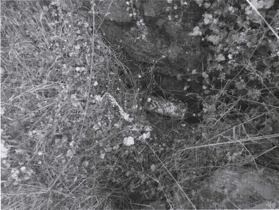
Foto n°7: tubo pluviale che scarica sul sedime del vicolo
