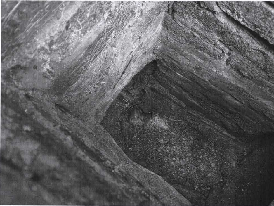
Foto n°6: pozzetto fognario, fondo scorrevole eroso
