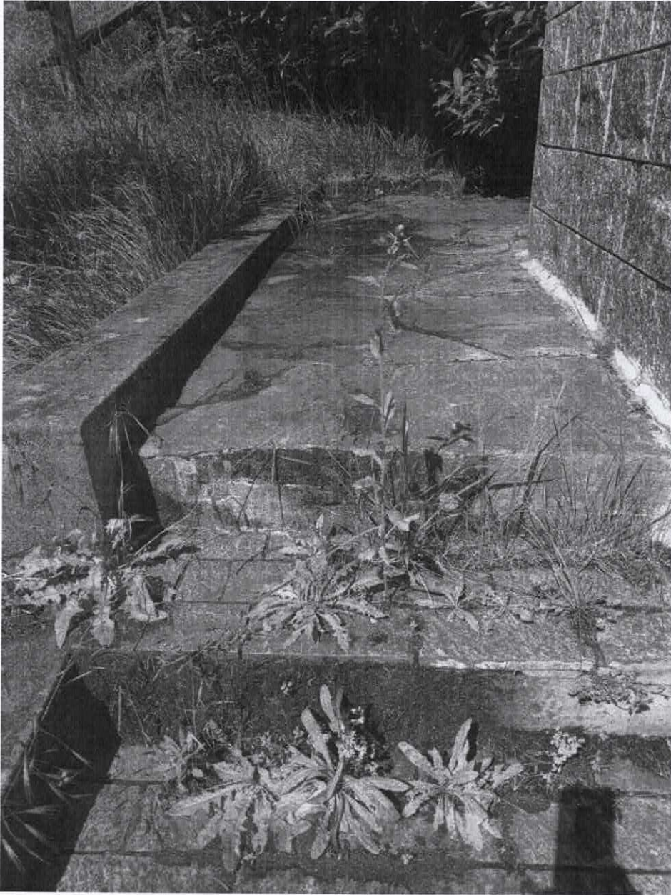
Foto n°12: ristagni d'acqua piovana e muffe presso il lastricato perimetrale dell'edificio
