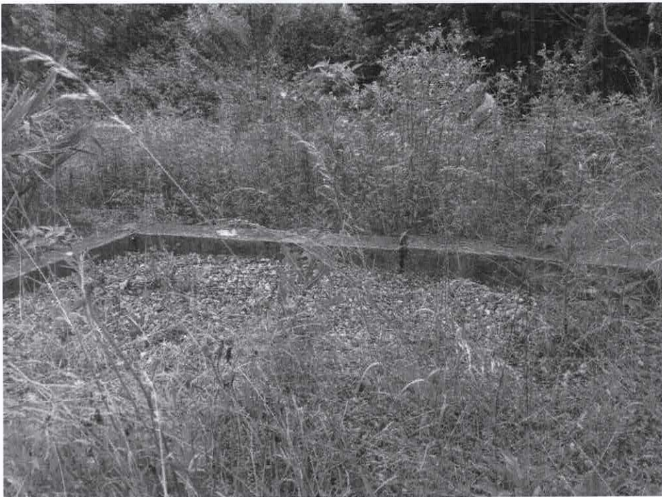
Foto n°14: cordolatura del cortile Sud fratturata e disarticolata
