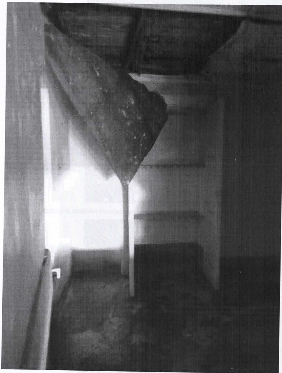
Foto n°28: marcescenza e crollo controsoffitto solaio di copertura del piano primo, acqua sul pavimento
