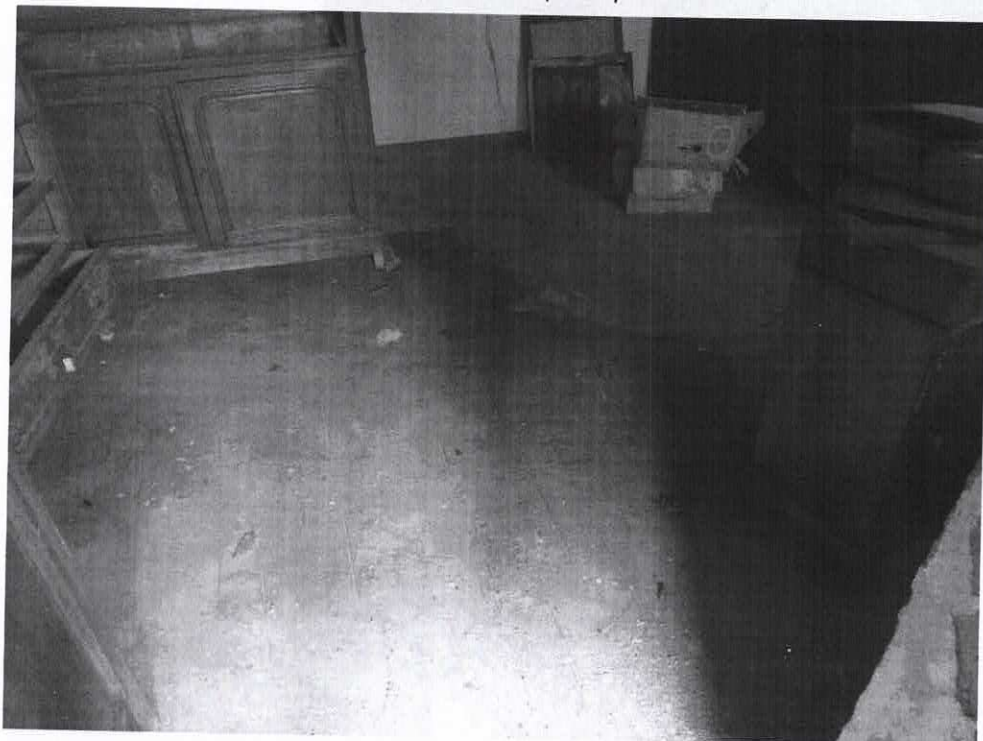
Foto n°26: pozze d'acqua sul pavimento del piano primo
