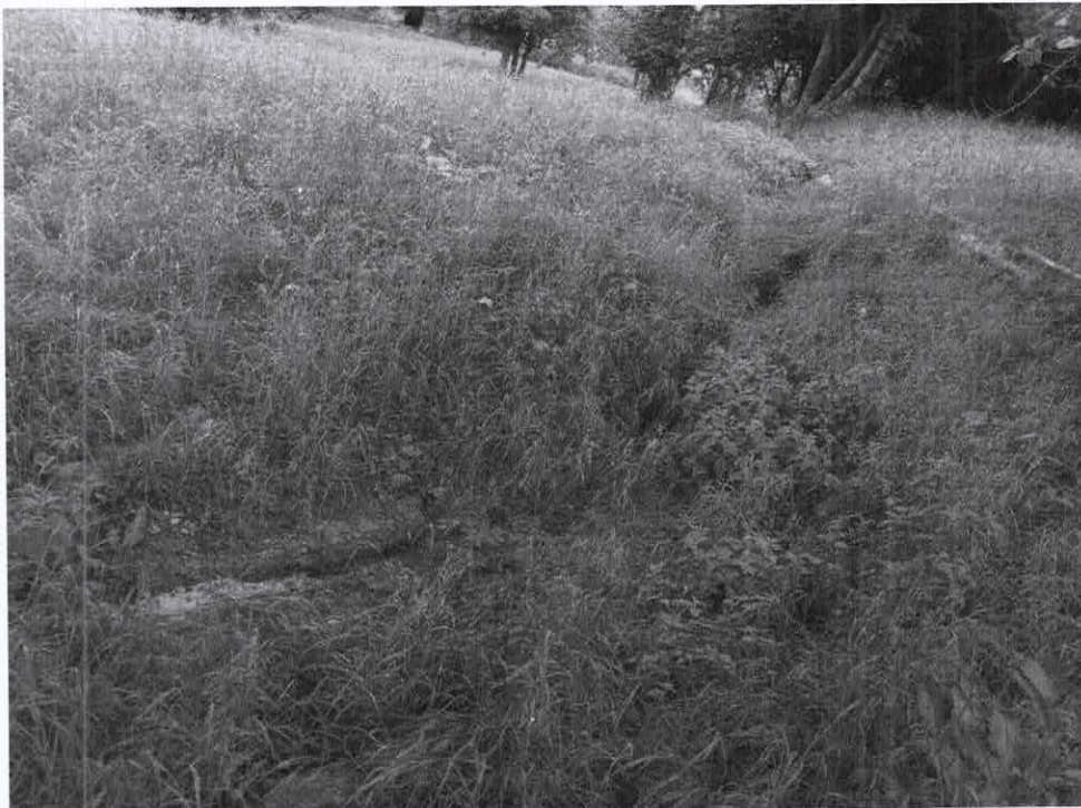
Foto n°18: reflui fognari che percorrono il versante prativo
