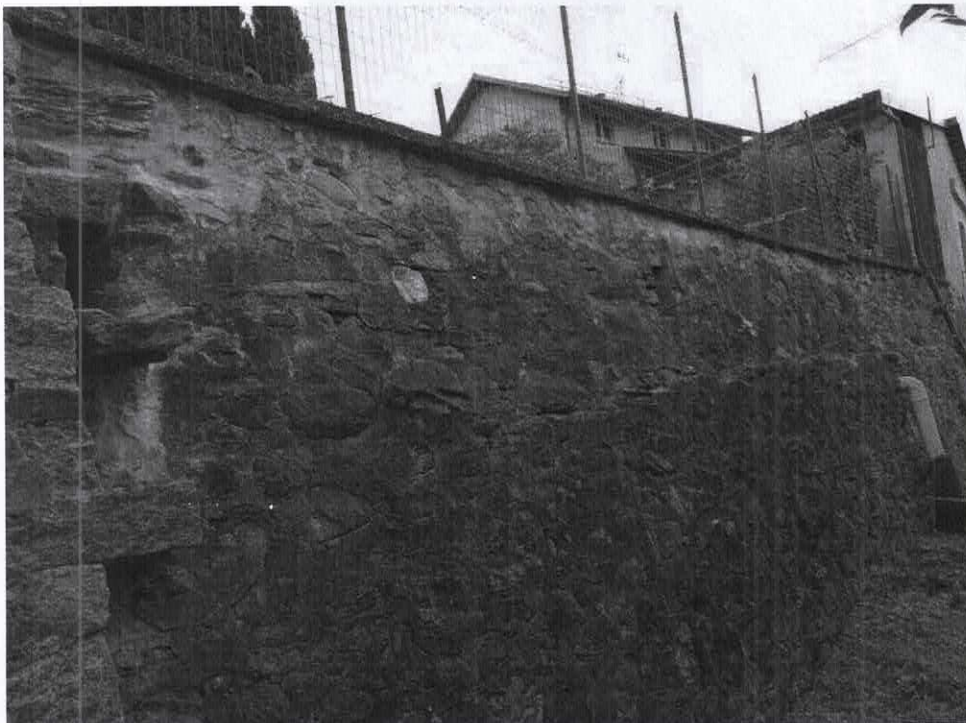
Foto n°8: doccioni e finestre nel muro che scaricano sul sedime del vicolo
