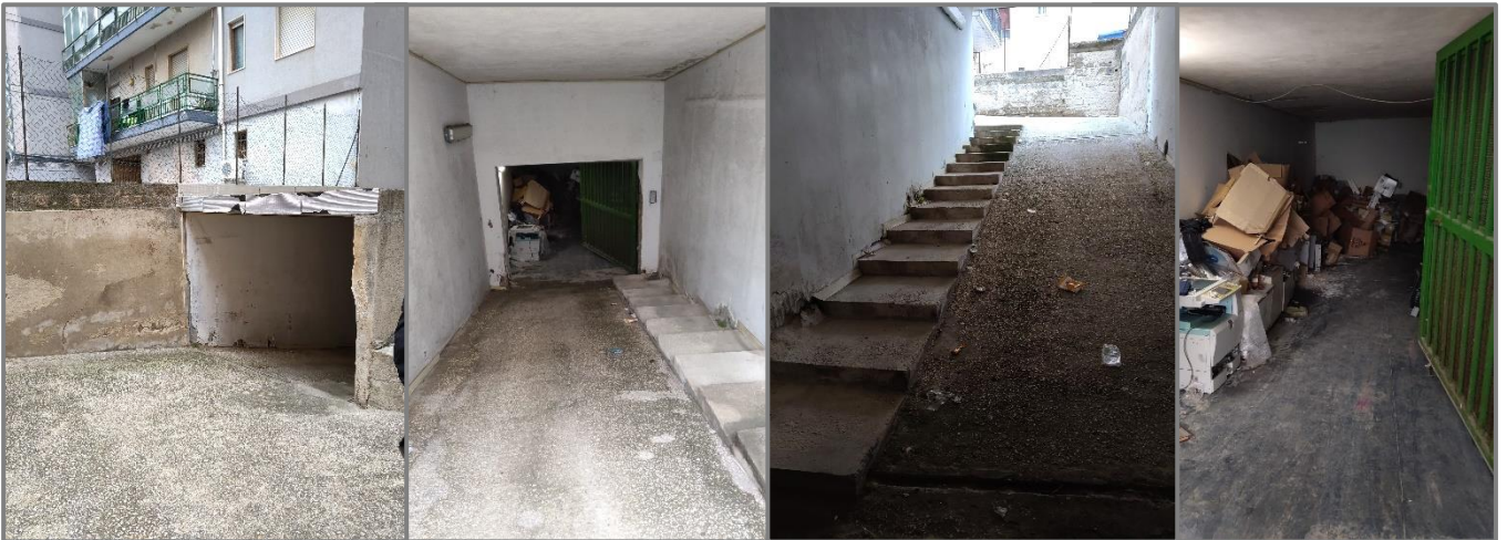
Fotografia con ingresso da scale esterne e accesso dal cancello per il seminterrato
