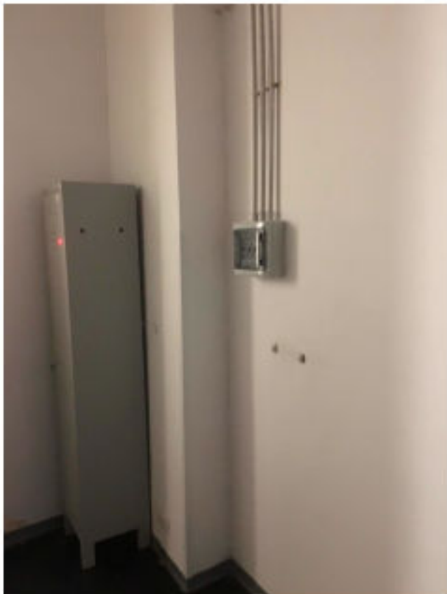
FOTO N. 30 QUADRO ELETTRICO GARAGE IN VIA BENEDETTO SCILLAMA' N. 56
