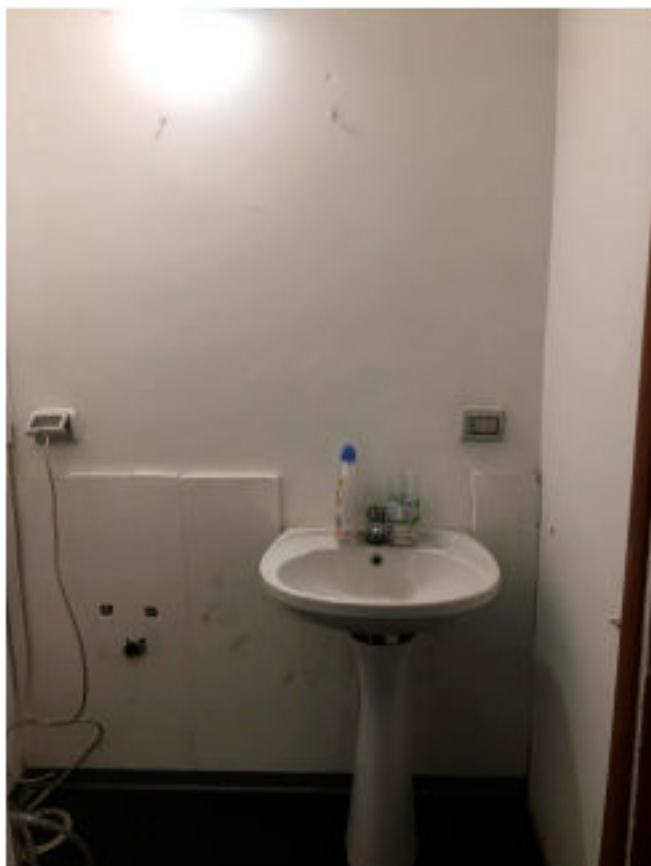
FOTO N. 32 LAVABO IN VIA BENEDETTO SCILLAMA' N. 56
