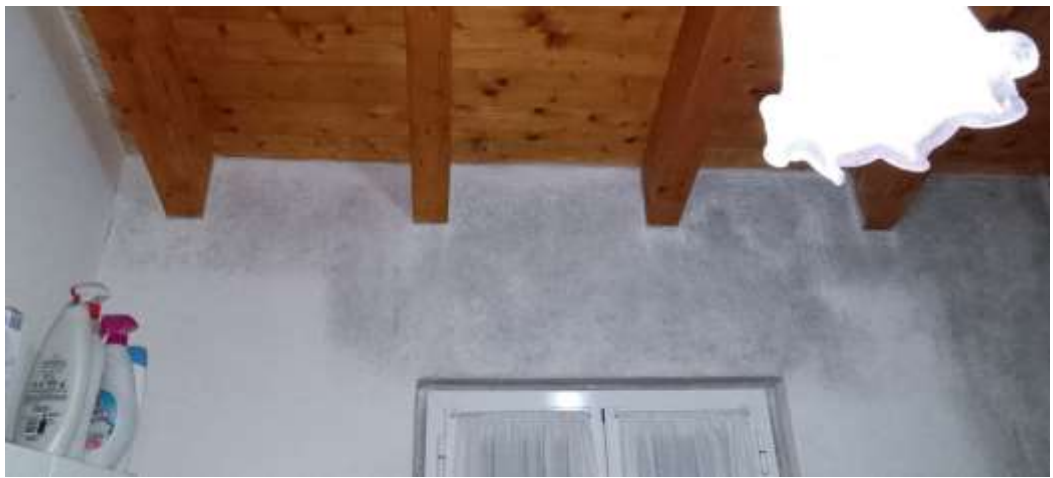
Foto 29 - Parete bagno piano 2°.
