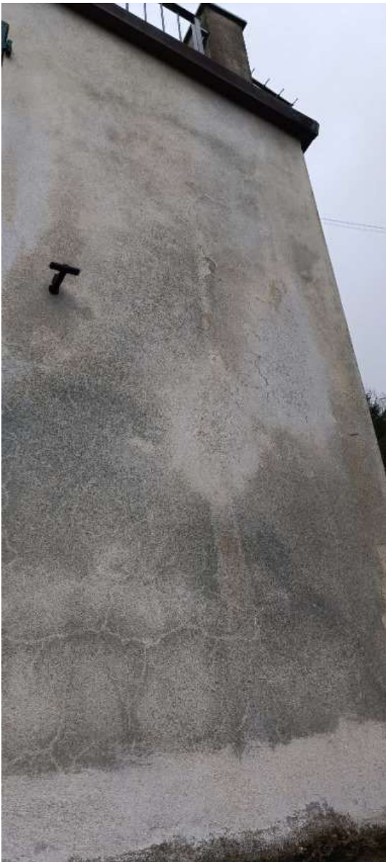
Foto 9 - Particolare della facciata ammalorata dall'umidità.
