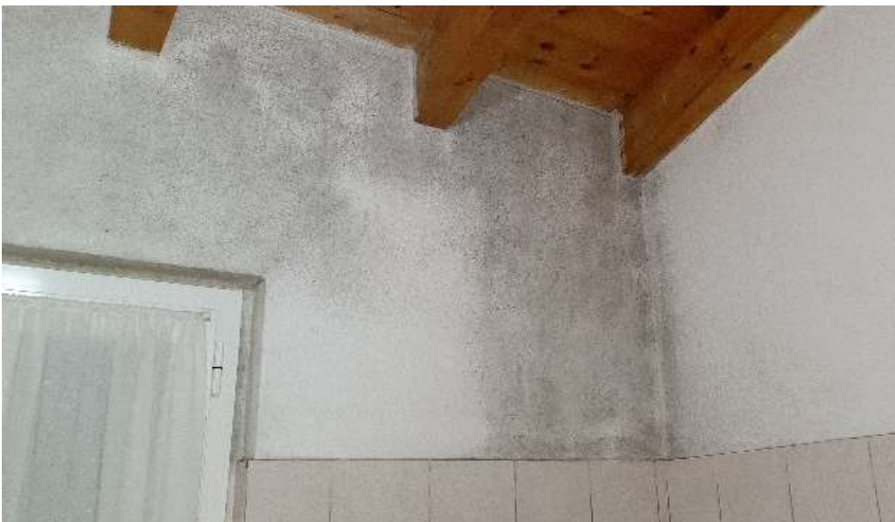
Foto 30 - Parete bagno piano 2°.
