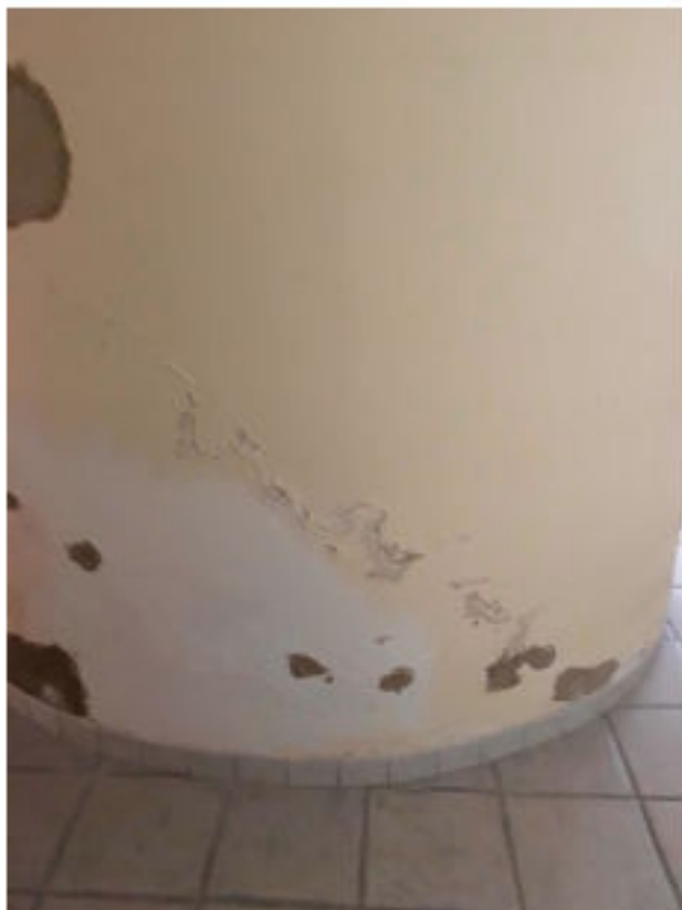
FOTO N. 41 UMIDITA' PARETE BAGNO LATO INGRESSO
