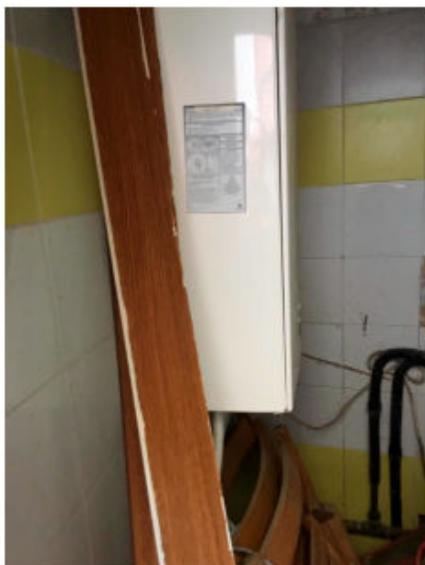
FOTO N. 75 LOCALE CALDAIA INTERNO
