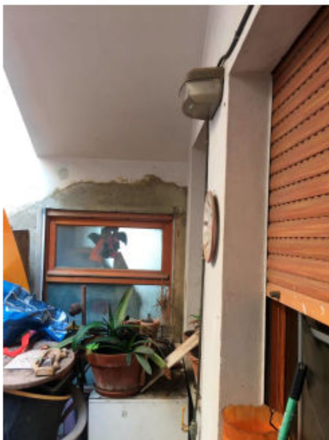
FOTO N. 68 FINESTRA LATO PATIO SOTTO SCALA
