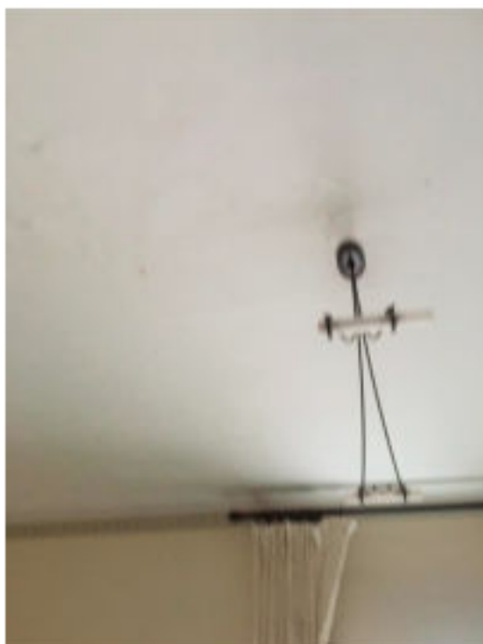
FOTO N. 98 UMITA' SOFFITTO CAMERA DA LETTO
