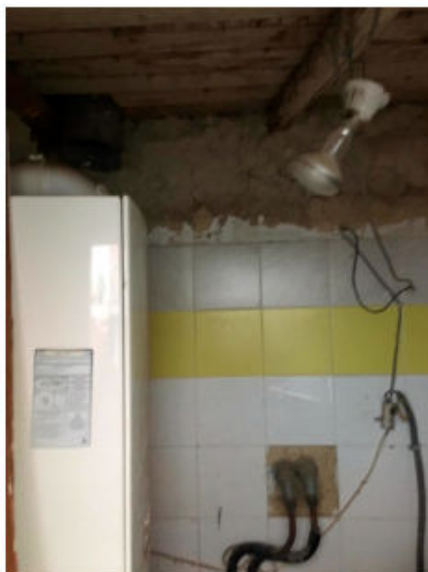
FOTO N. 76 LOCALE CALDAIA INTERNO
