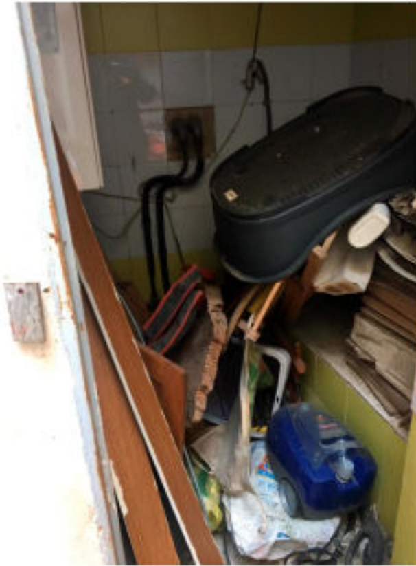
FOTO N. 77 LOCALE CALDAIA INTERNO
