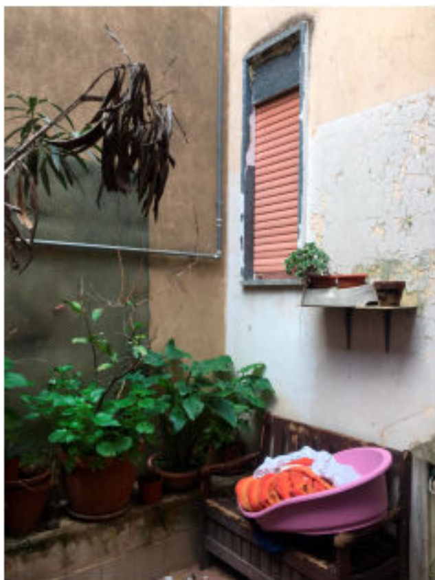
FOTO N. 80 PATIO VISTA FINESTRA SCALA
