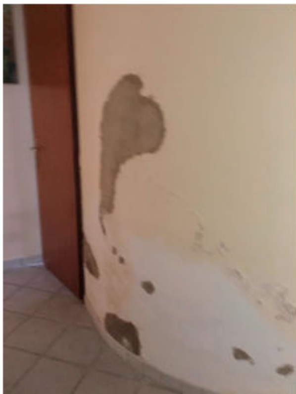
FOTO N. 42 UMIDITA' PARETE BAGNO LATO INGRESSO
