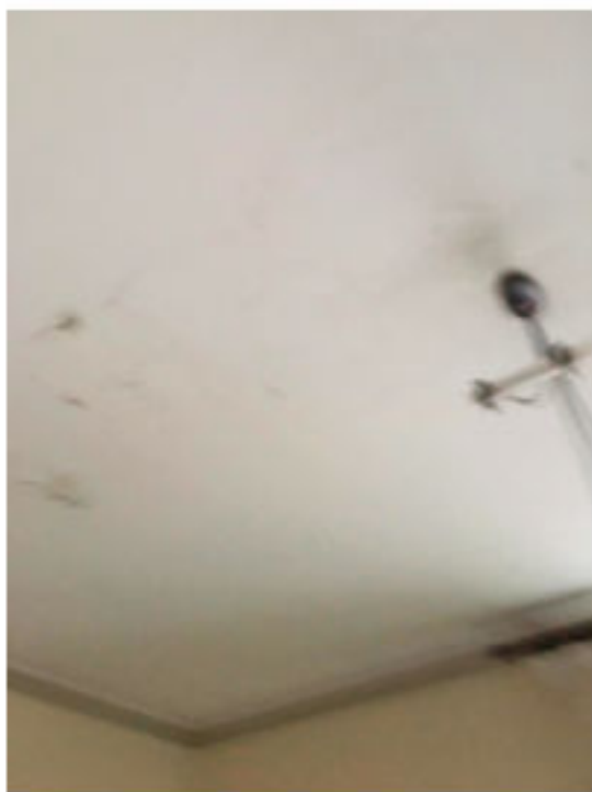
FOTO N. 97 UMITA' SOFFITTO CAMERA DA LETTO
