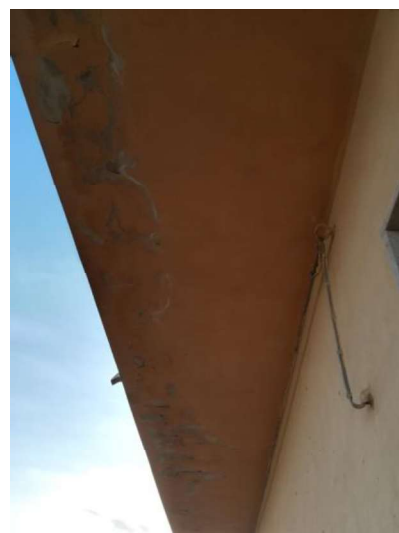
foto 30 – macchie di umidità nei cornicioni
