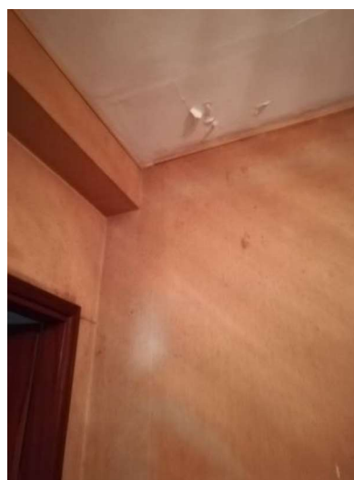
foto 16 – macchie di umidità nella camera
