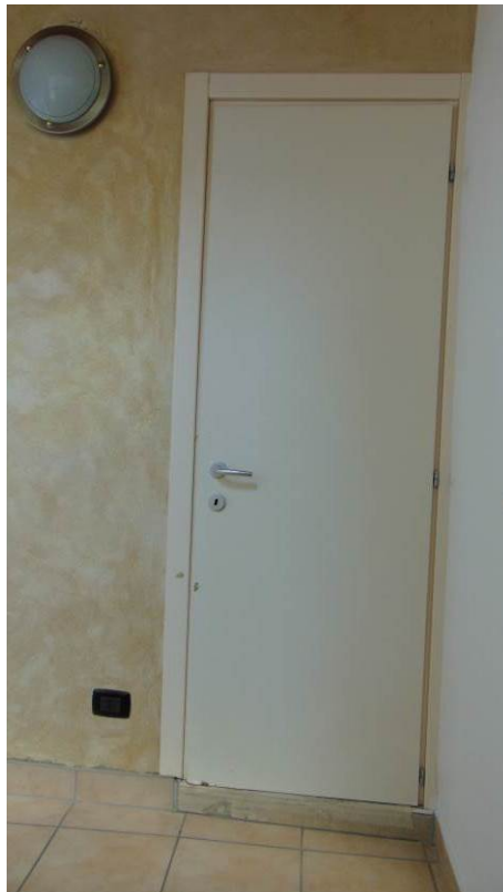
Foto 29_ Dettaglio porta del bagno al piano primo
