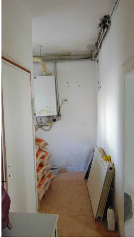
Foto 13_Vano con Caldaia
