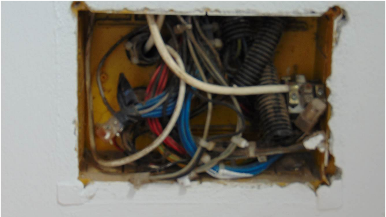
Foto 30_Dettaglio stato degli impianti nella zona giorno
