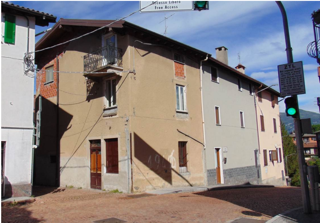
Foto 1_Prospetti su vai Asmara e XXXXXX con ingresso secondario in stradina laterale
