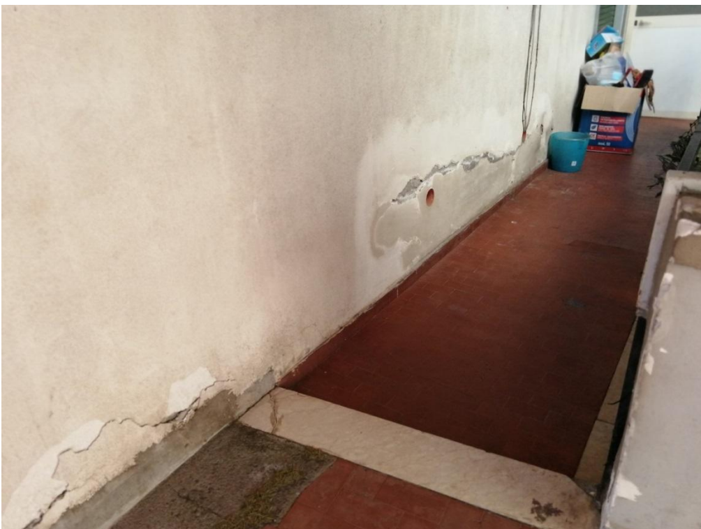
FO-L1-15 APERTURA ARBITRARIA DEL BALCONELATO CUCINA/SOGGIORNO CHE PERMETTE L'ACCESSO ALL'AREA CONDOMINIALE
