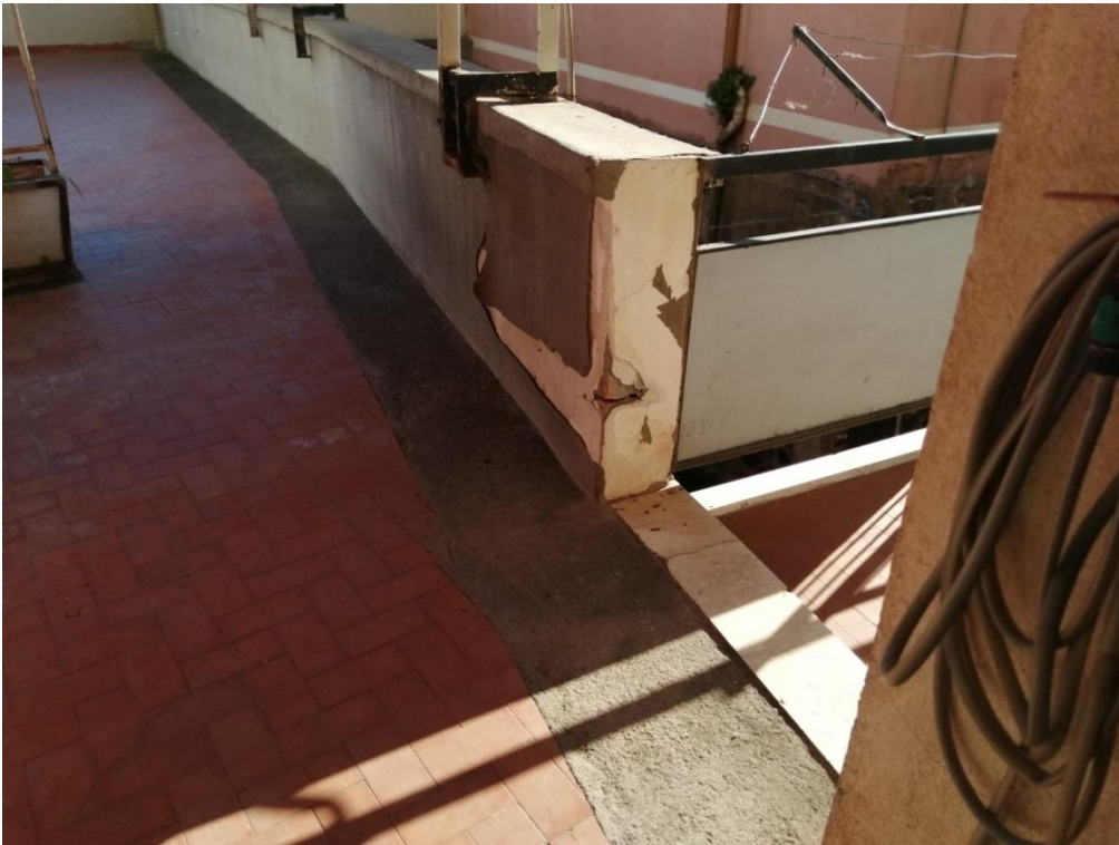
FO-L1-14 APERTURA ARBITRARIA DEL BALCONELATO VANI LETTO CHE PERMETTE L'ACCESSO ALL'AREA CONDOMINIALE
