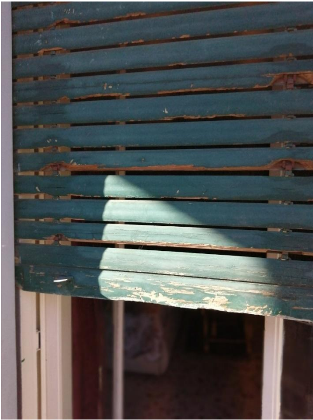
FO-L1-18 RIFINITURE IMMOBILE – INFISSI ESTERNI - CONDIZIONI
