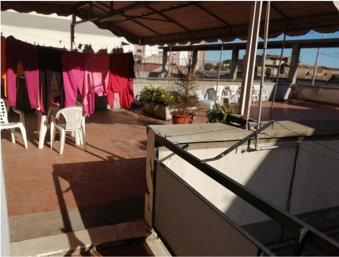
FO-L1-16 APERTURA ARBITRARIA DEL BALCONE - AREA CONDOMINIALE
