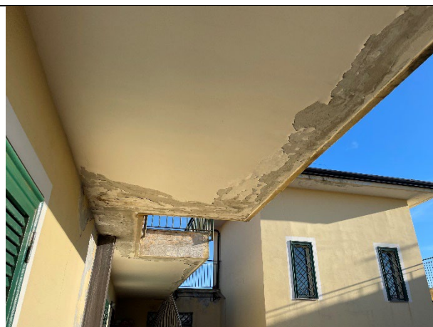
Balcone 2 con presenza infiltrazioni
