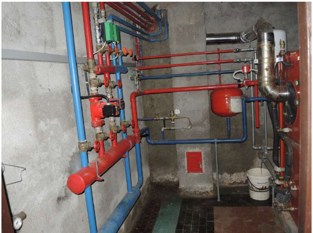
Piano terra - Locale caldaia
