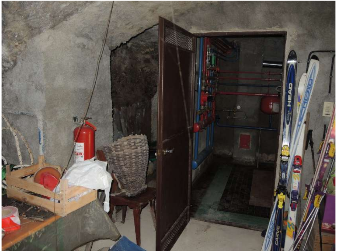
Piano terra - Locale caldaia
