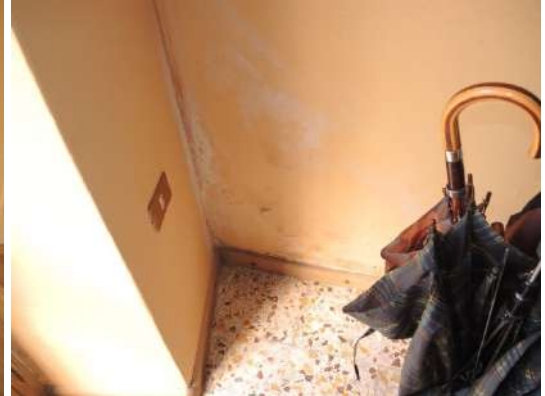
PT - Atrio ingresso - particolare muffa
