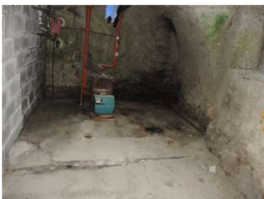
S1 - centrale termica e cisterna gasolio
