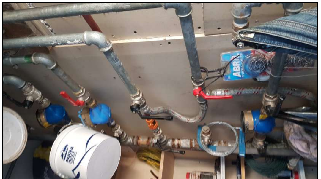
TUBATURE IMPIANTO IDRICO SANITARIO (contatori) – piano terra
