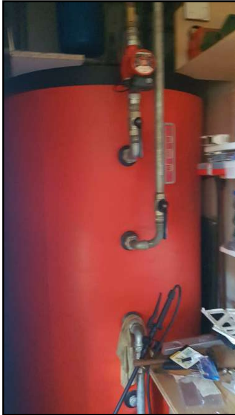
BOLLITORE IMPIANTO RISCALDAMENTO (comune) – piano terra
