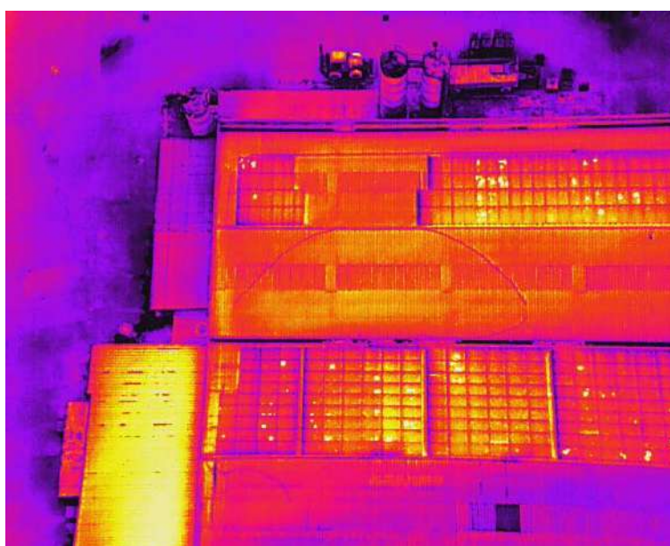
Figura 6 - Termogramma n.3_ Impianto ██████
