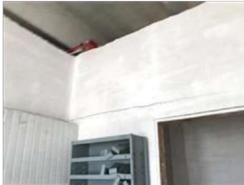
piano interno appartamento - vano interno fessurazioni
