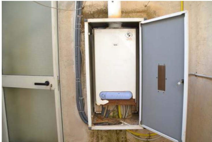
Figure 13 - caldaia a gas collocata nel pozzo luce p.2°
