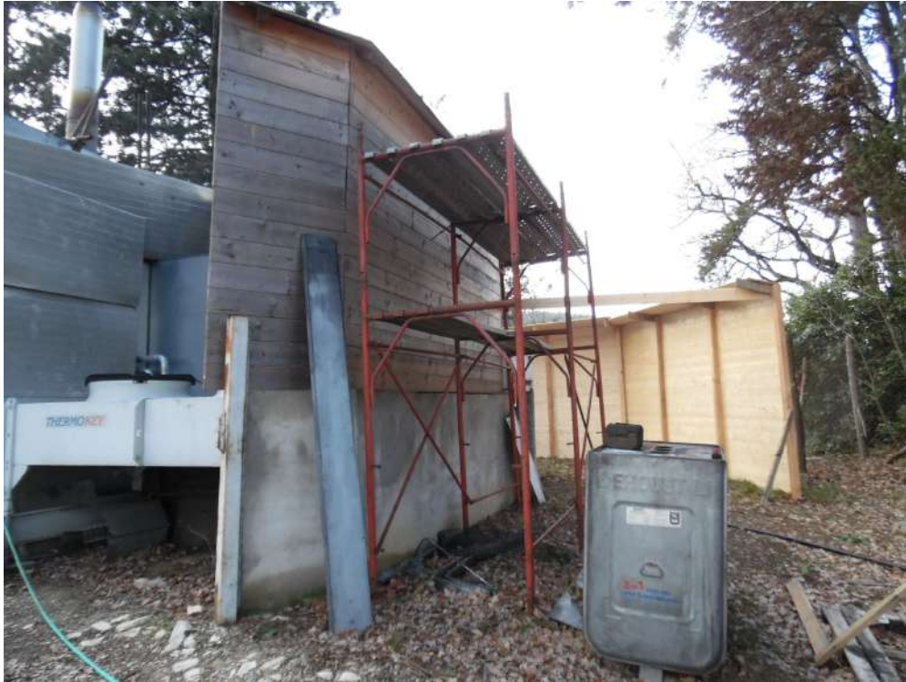
FOTO 27 – Vista esterna locale macchine
