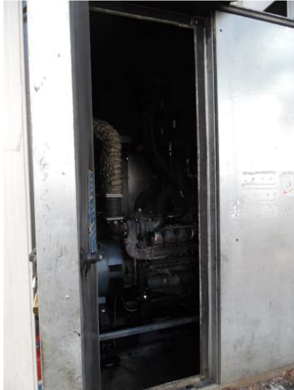
FOTO 25 – Vista locale macchine (5)
