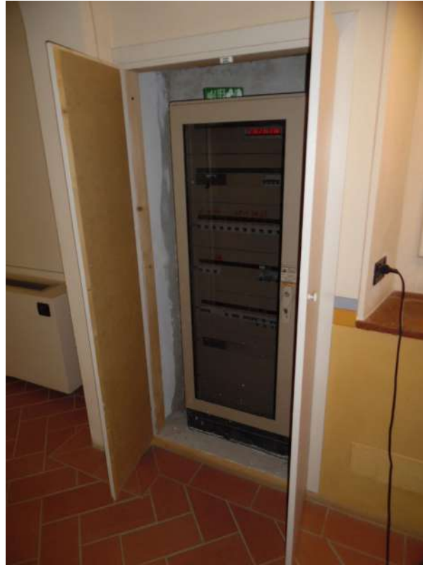
FOTO 35 – Vista quadro elettrico
