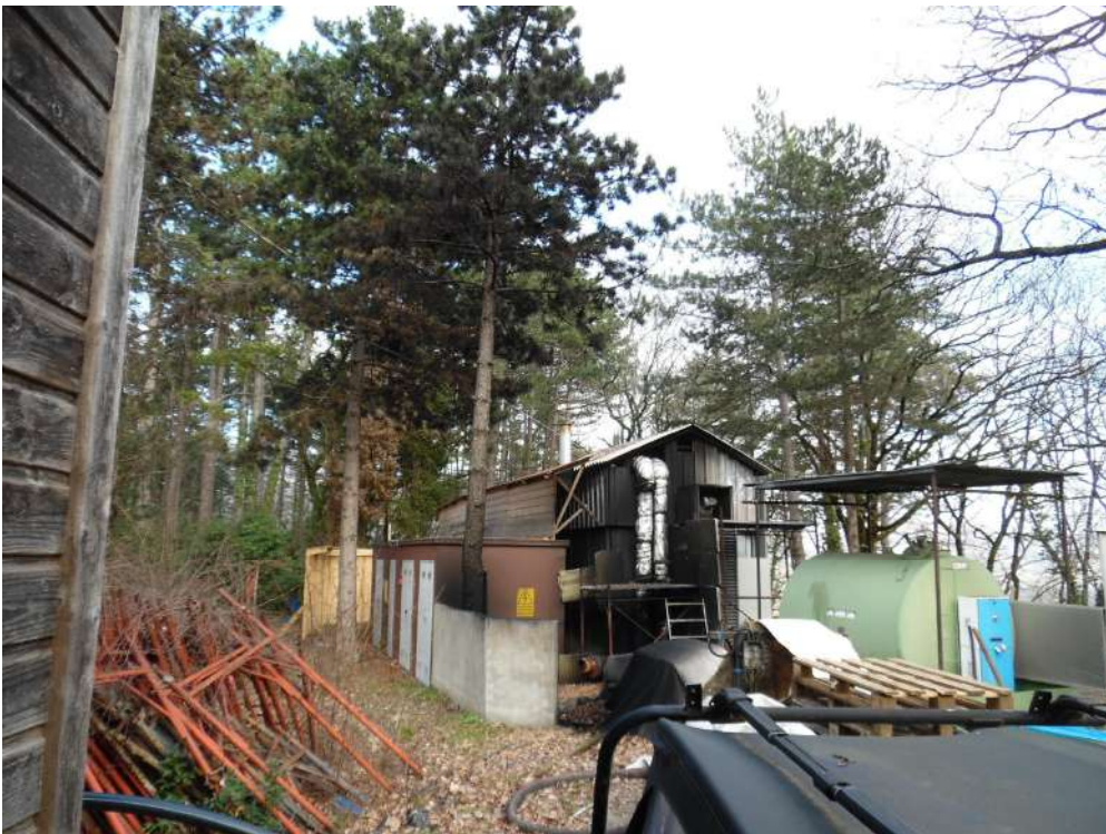
FOTO 8 – Vista esterna generatori (3-4)
