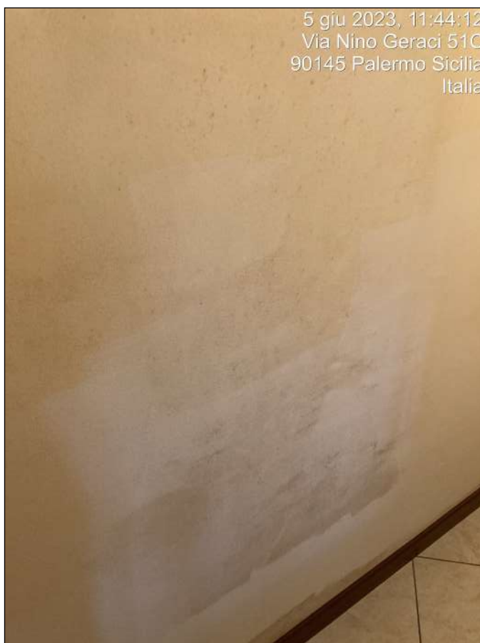
Foto n. 16 - Interni: segni di umidità di condensa lungo il corridoio in corrispondenza dei pilastri
