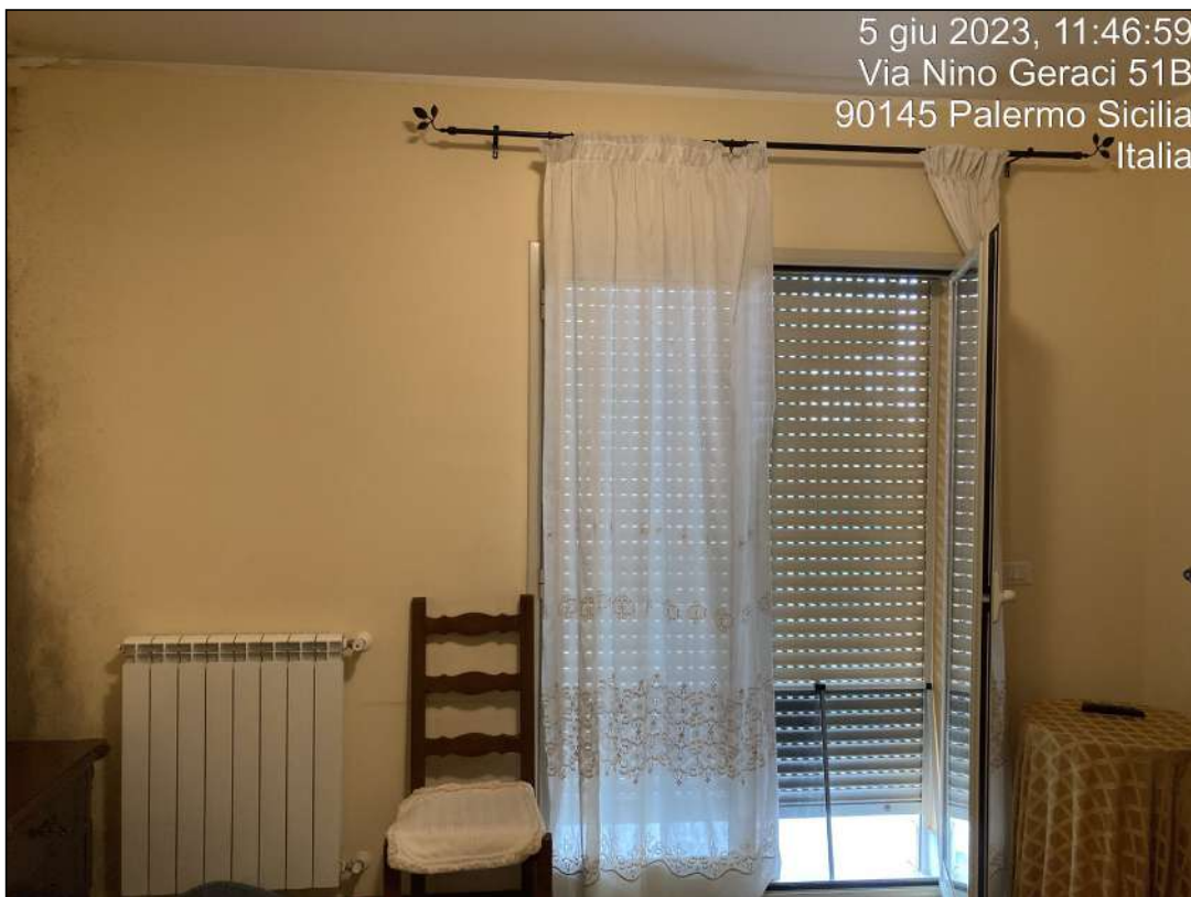
Foto n. 24 - Interni: camera da letto matrimoniale con problemi di umidità/condensa
