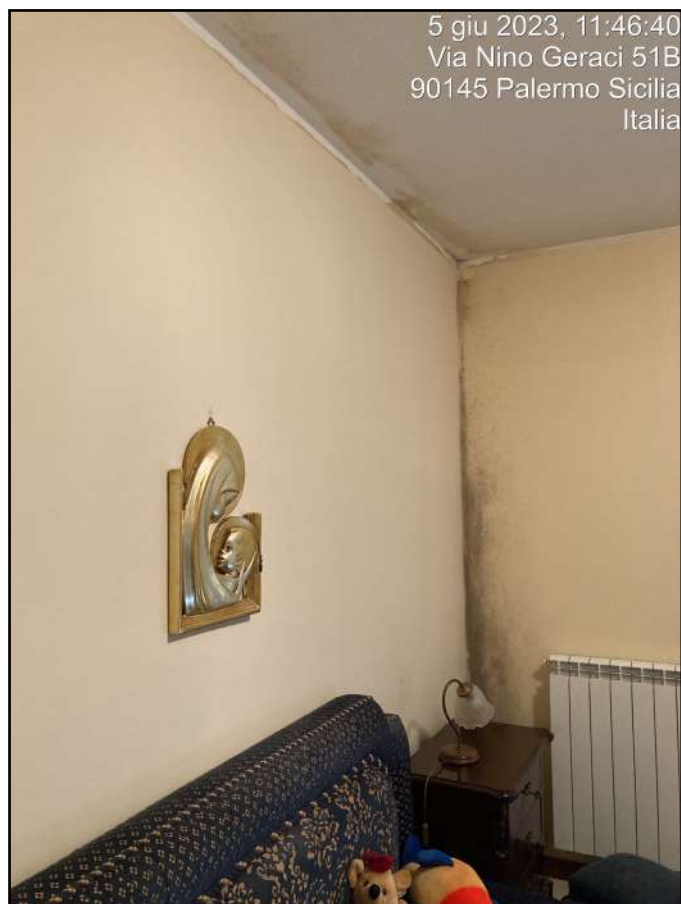
Foto n. 25 - Interni: segni di umidità da condensa nella camera da letto matrimoniale
