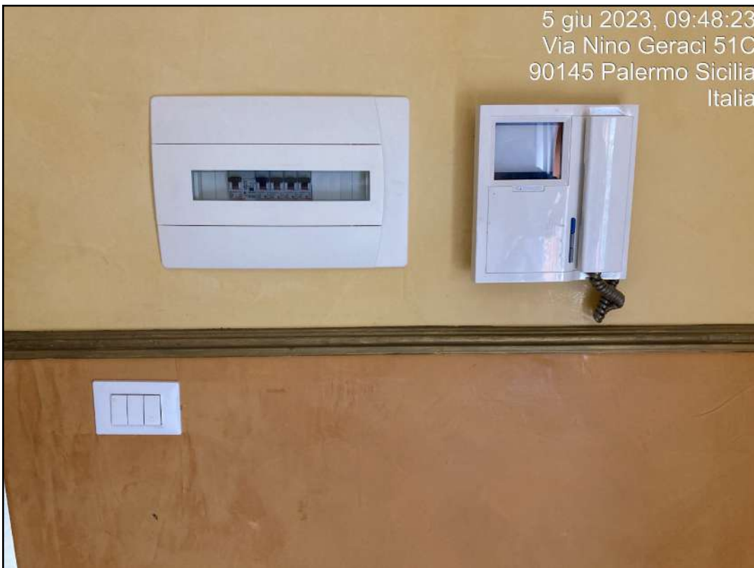
Foto n. 12 - Interni: dettaglio quadro elettrico e videocitofono
