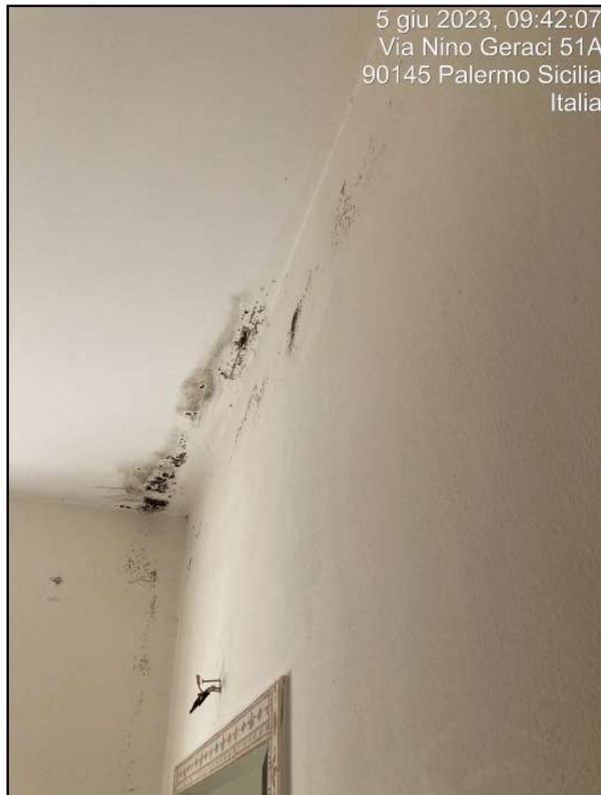
Foto n. 20 - Interni: w.c. con doccia - dettaglio condensa angolo parete/soffitto
