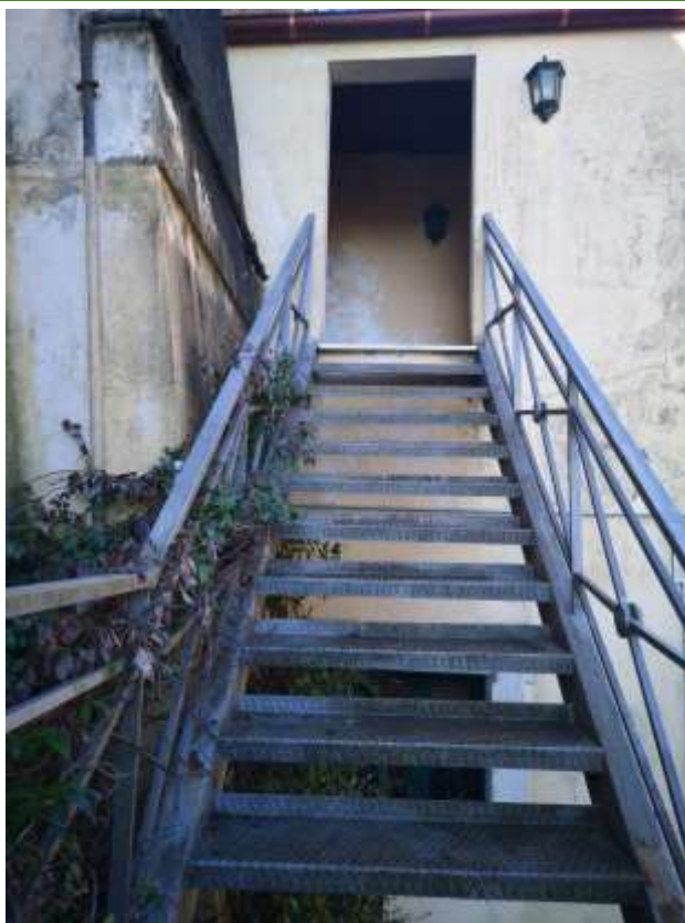
Foto 19 - locale deposito piano 2° sub 17 - vano su scala esterna in ferro non autorizzato
