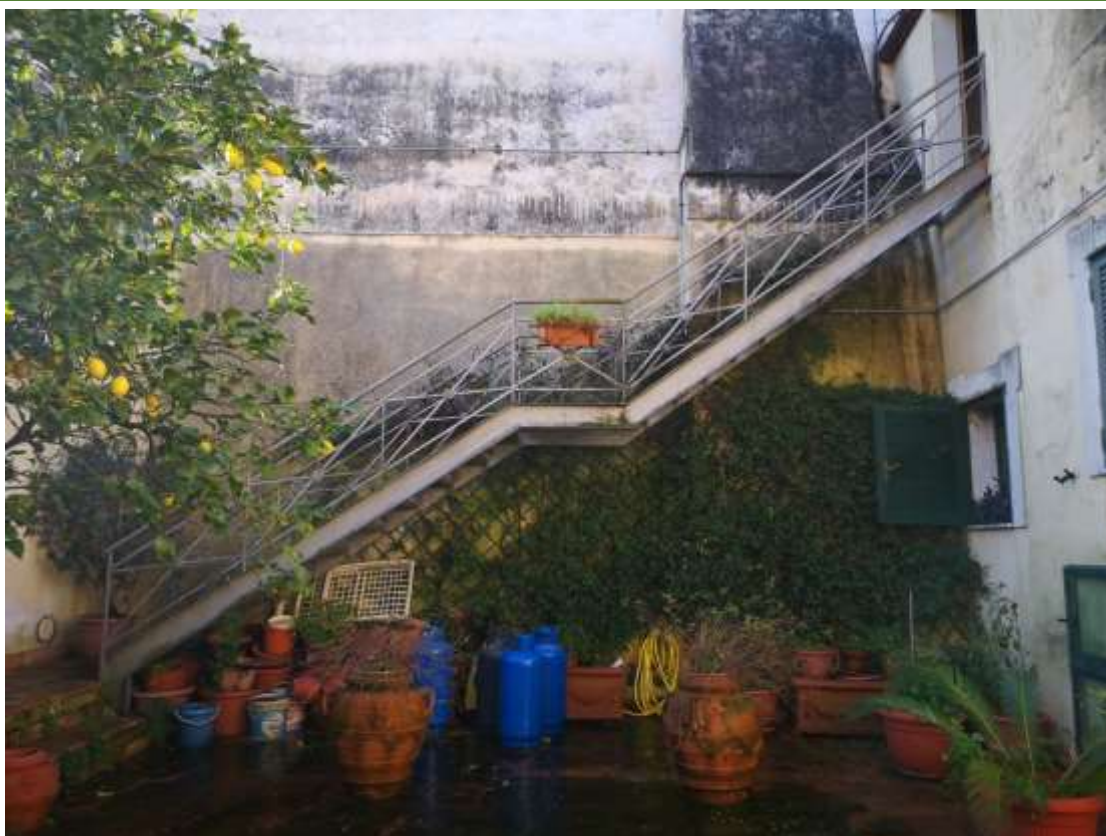
Foto 20- locale deposito piano 2° sub 17 - vano su scala esterna in ferro non autorizzato
