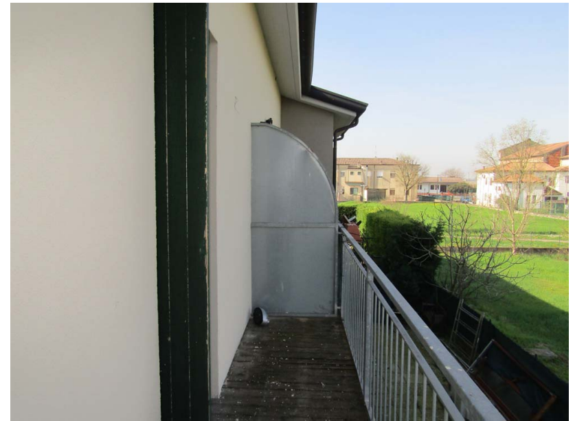
Foto 18: balcone di una camera a nord-ovest
