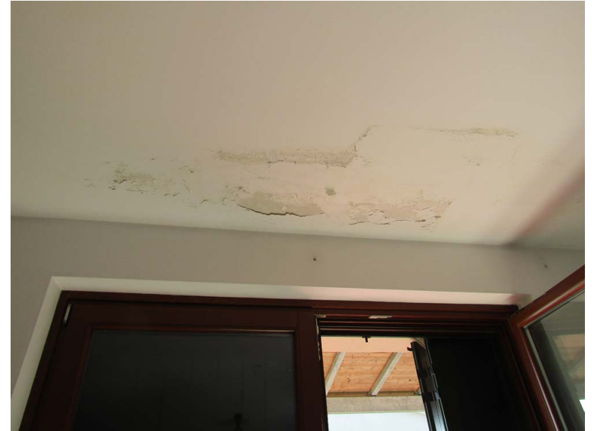
Foto 10: dettaglio delle infiltrazioni del soggiorno
