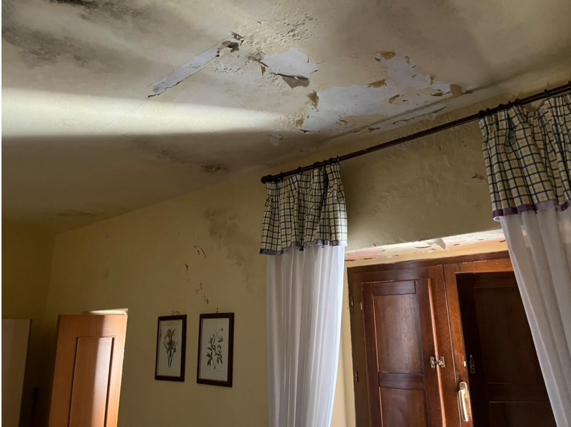
Foto 25 – particolare dei fenomeni di umidità e distacco degli intonaci nella camera da letto1 al piano primo
