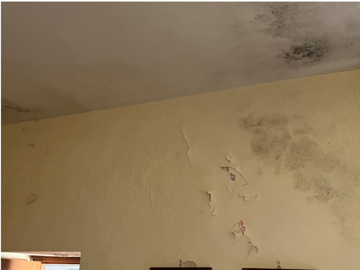
Foto 42 – dettaglio dei fenomeni di umidità, muffe e distacco degli intonaci nella camera da letto 1 al piano primo, lato bagno
