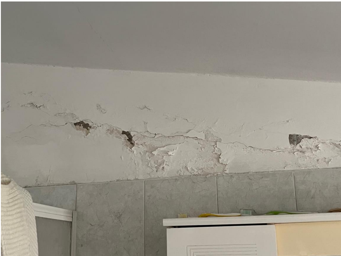
Foto 36 – dettaglio dei fenomeni di umidità e distacco dell'intonaco nel bagno al piano
