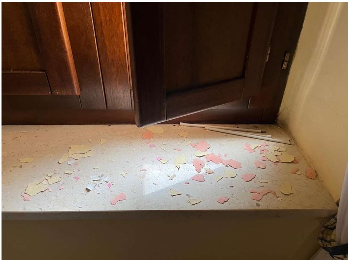
Foto 30 – frammenti d'intonaco sul davanzale della finestra nella camera da letto 1 al piano primo, distaccatisi dal soffitto
