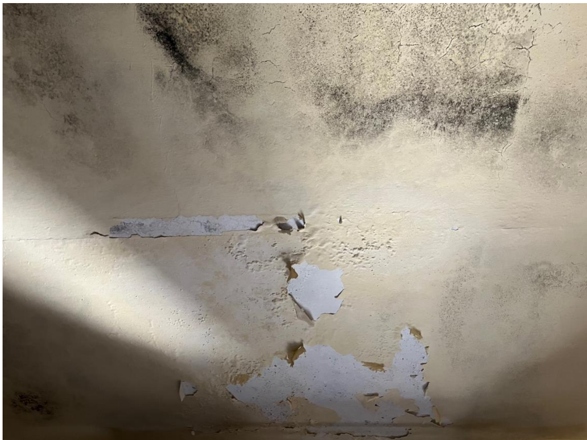
Foto 28 – dettaglio dei fenomeni di umidità, infiltrazioni, muffa e distacco degli intonaci
