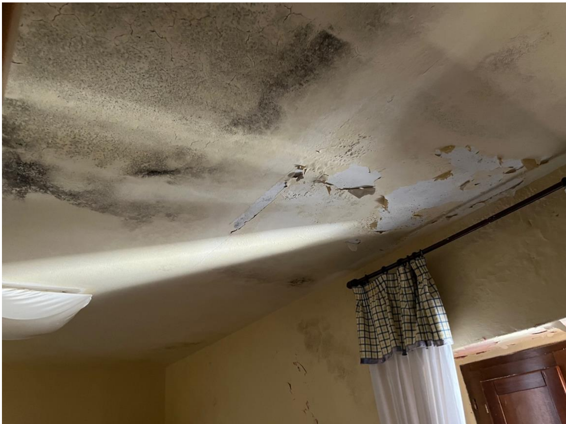
Foto 26 – particolare dei fenomeni di umidità e distacco degli intonaci nella camera da letto 1 al piano primo
