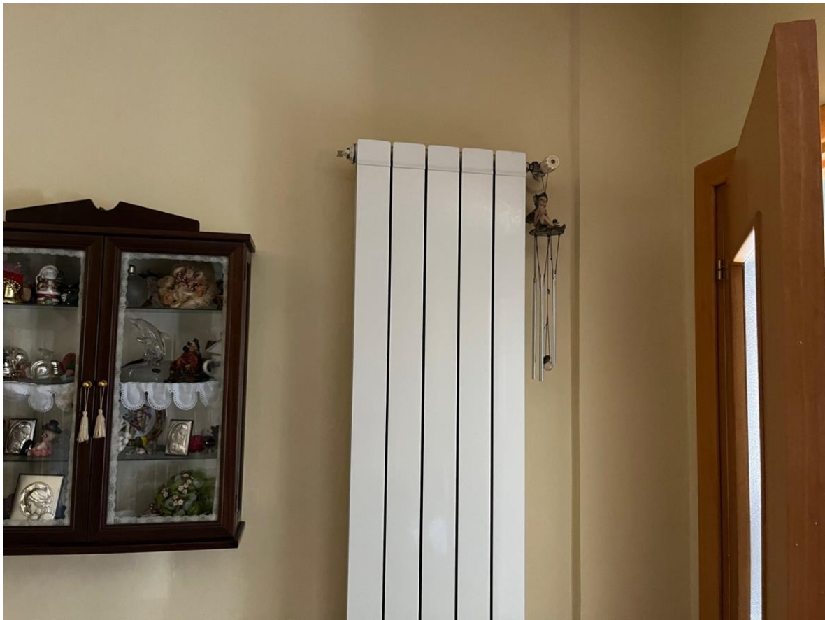
Foto 21 – particolare del termosifone in alluminio nella cucina
