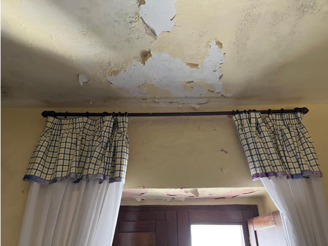
Foto 27 – particolare dei fenomeni di umidità e distacco degli intonaci nella camera da letto1 al piano primo
