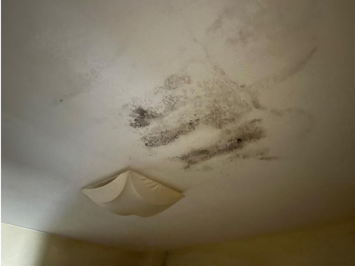
Foto 41 – dettaglio dei fenomeni di umidità e muffe nella camera da letto 2 al piano primo
