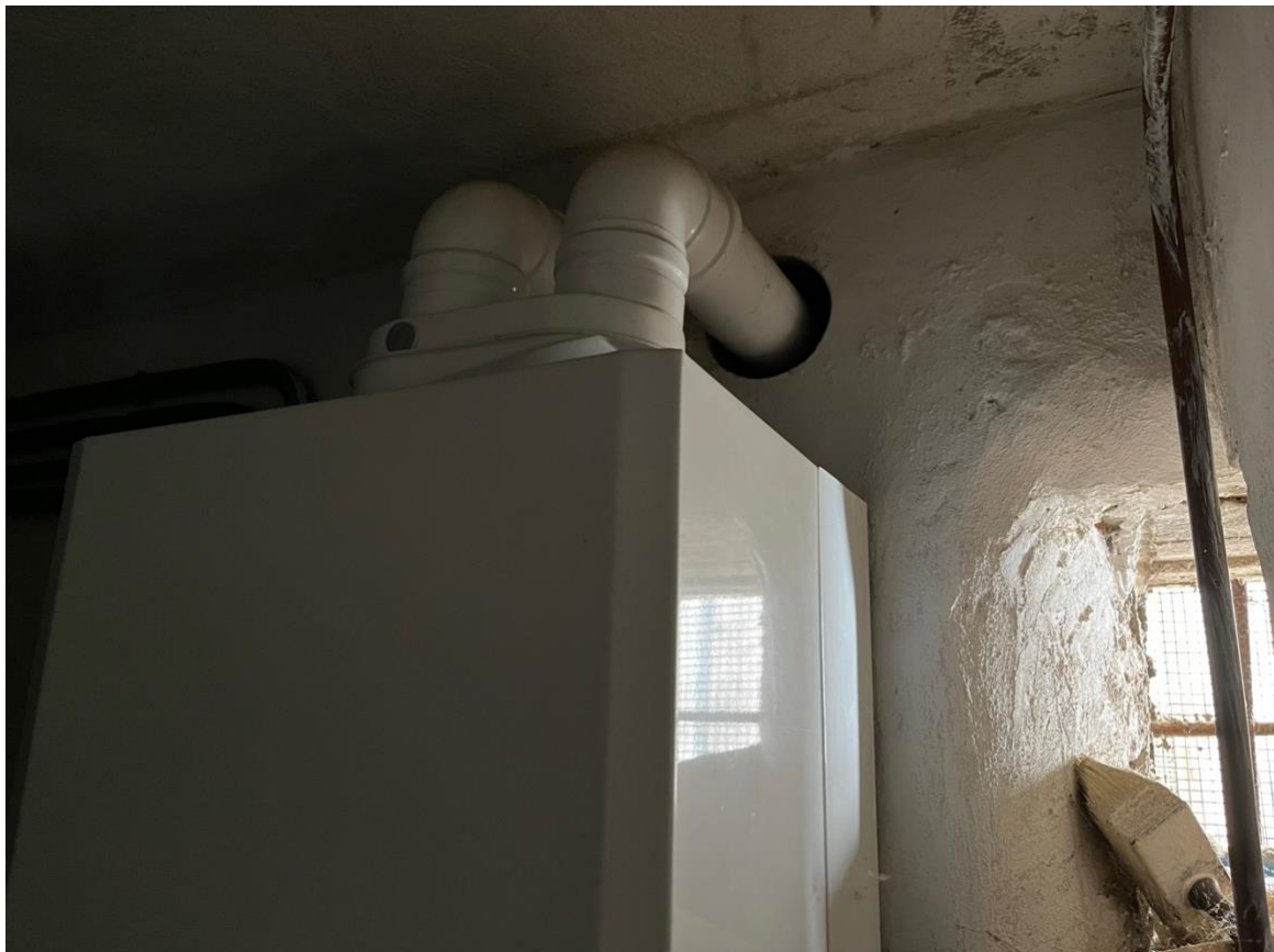
Foto 48 – particolare della caldaia nel ripostiglio del vano cantina
