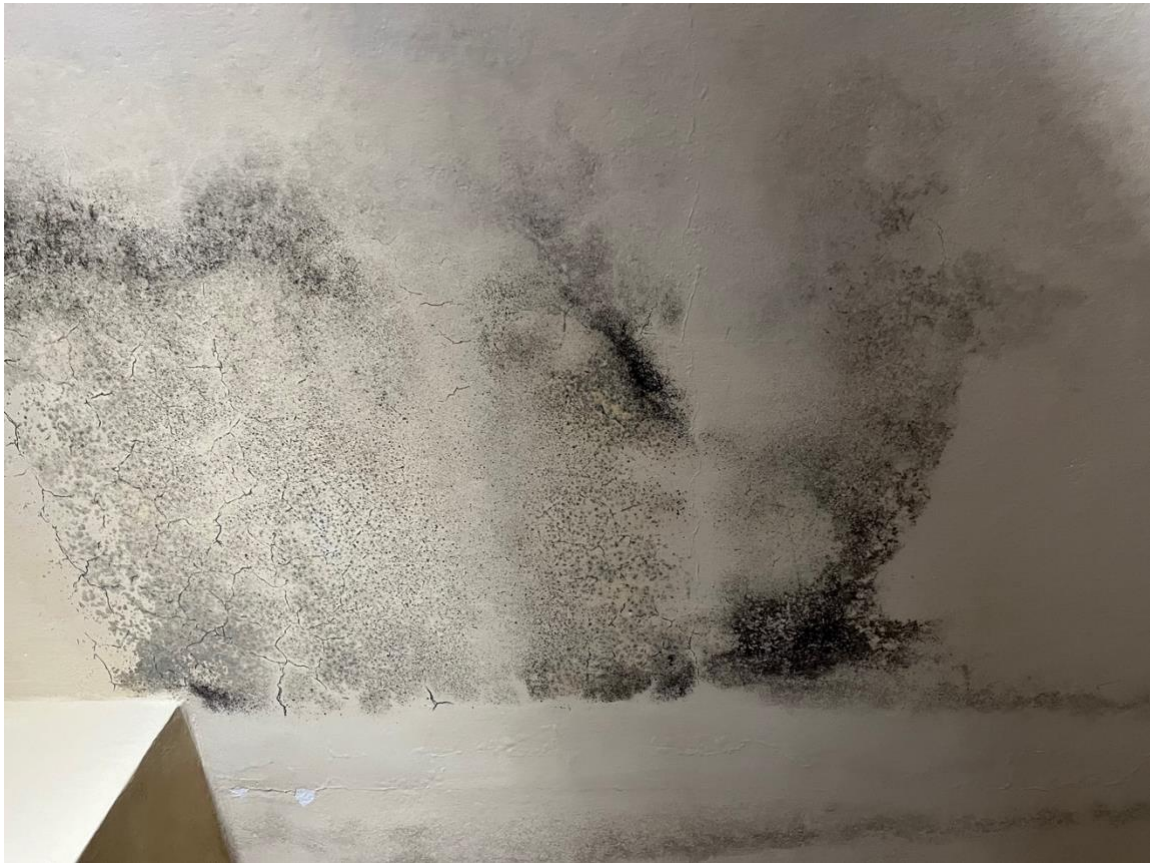
Foto 29 – dettaglio dei fenomeni di umidità e muffa sul soffitto della camera da letto 1 al piano primo
