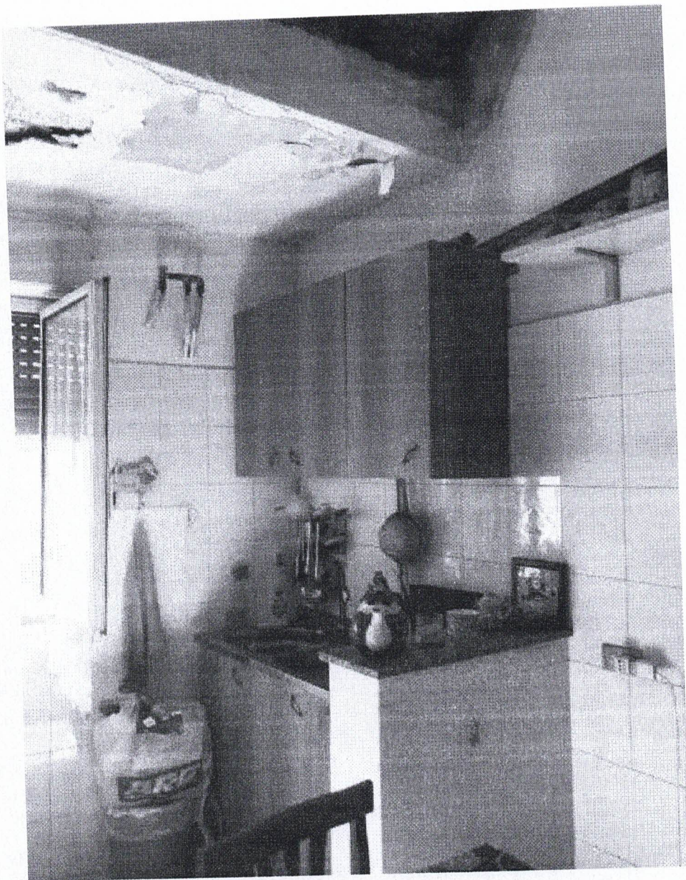
Cucina si vede la chiusura del balcone e il soffitto ammalorato
