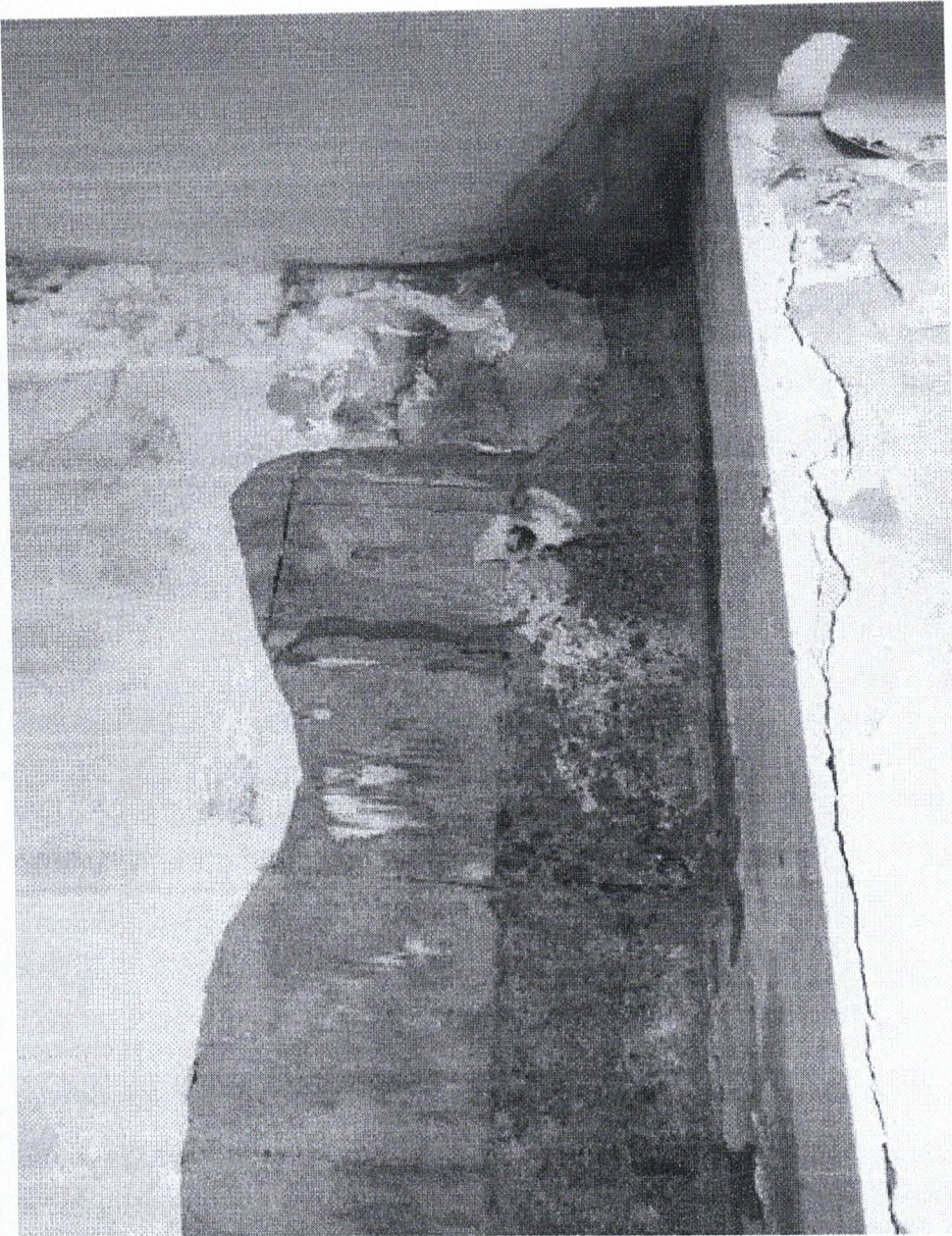
Ammaloramento del soffitto della cucina
