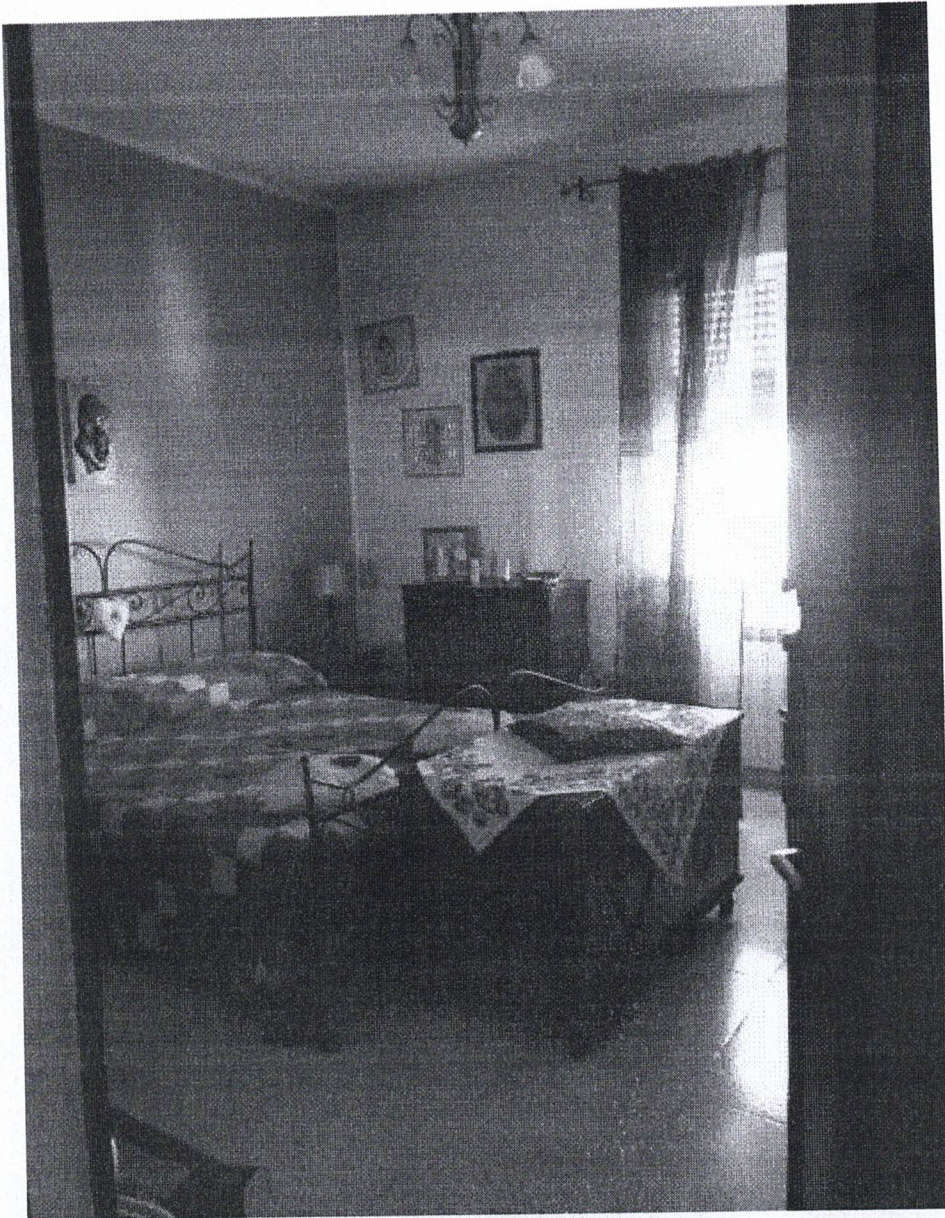
Camera da letto matrimoniale con evidenti macchie d'umidità
