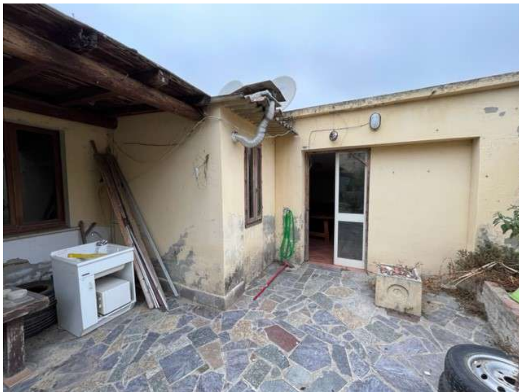
Fotografia 35 – Vista del locale ripostiglio abusivo dal cortile
