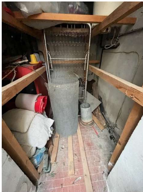
Fotografia 16 – Vista della centrale termica
