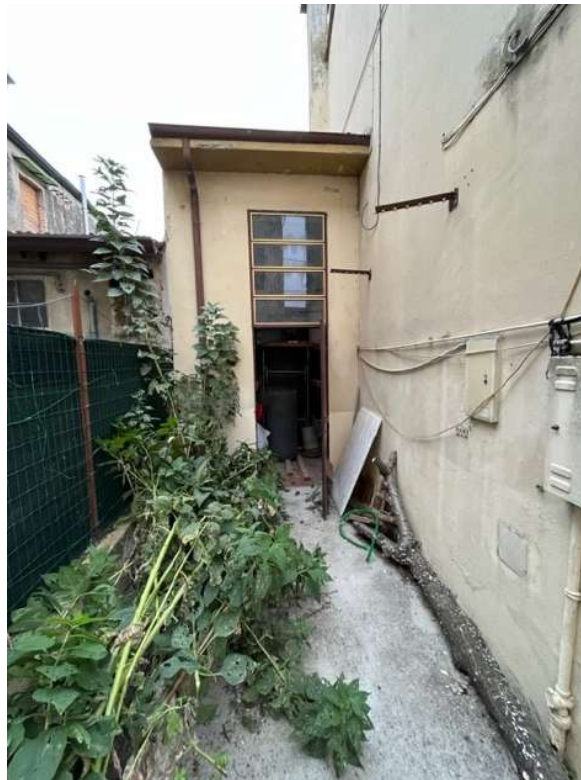
Fotografia 15 – Vista della centrale termica con accesso dal cortile comune
