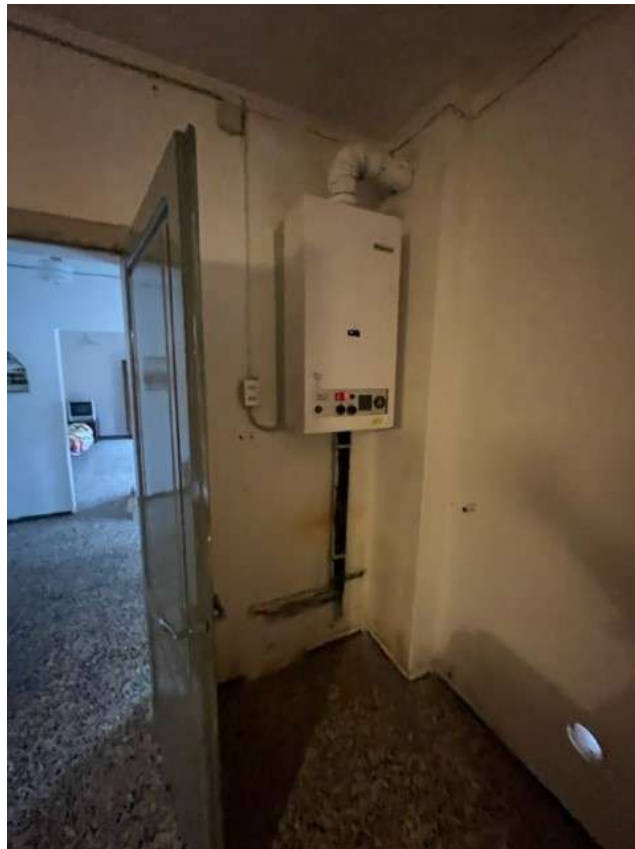
Fotografia 23 – Caldaia al piano secondo
